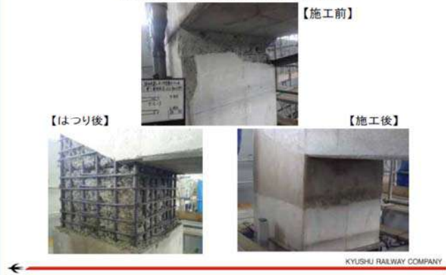
土木学会 2016年熊本地震1周年報告会 公開資料より 105
