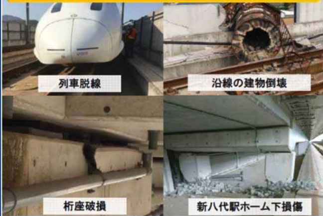
土木学会 2016年熊本地震1周年報告会 公開資料より 103
