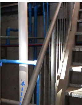
空気抜き配管
