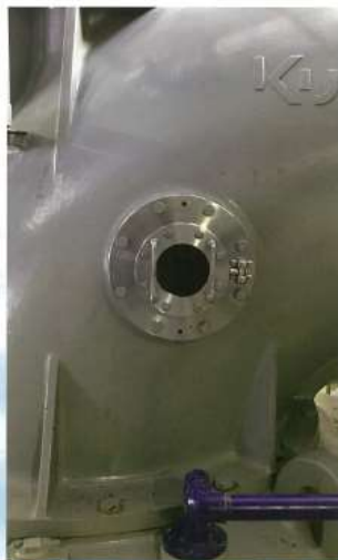
内部診断用窓
