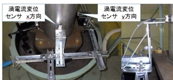
&lt;S排水機場 1号機&gt;
