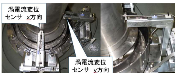
&lt;S排水機場 2号機&gt;
