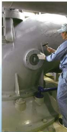
既存ポンプ設備点検窓
