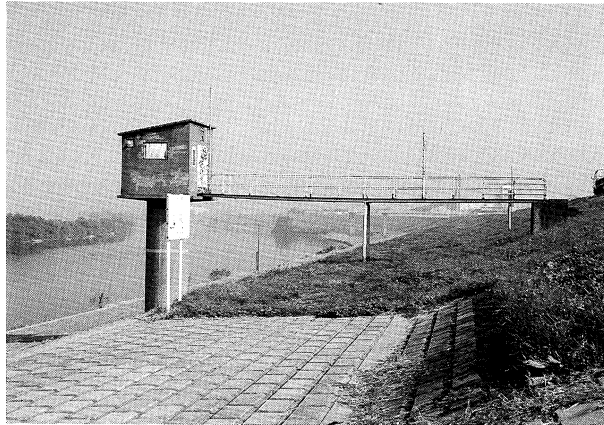
写真 3・1・1 水位観測所（江戸川工事事務所 流山観測所）
