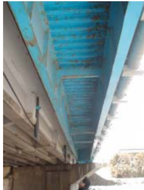
図 3.7 腐食が進行した鋼製歩道橋の事例
