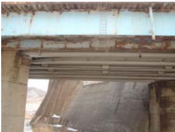
図 3.6 腐食が進行した鋼製歩道橋の事例
