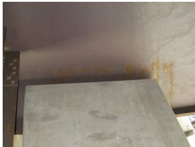
写真-3.2.7 さび発生箇所（素地調整が難しい箇所）
