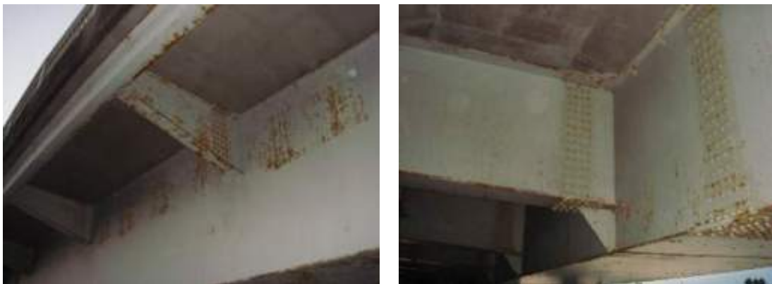
写真-3.2.13 塗替塗装前の塗膜外観
