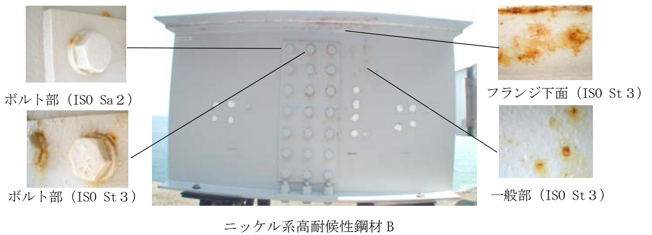
写真-4.3.11 暴露5年経過後の各試験体の外面山側の状況
