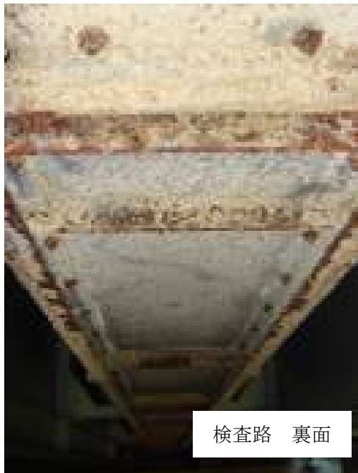
写真-3.3.12 塗膜および溶融亜鉛めっき鋼材の外観（脇谷川橋）
