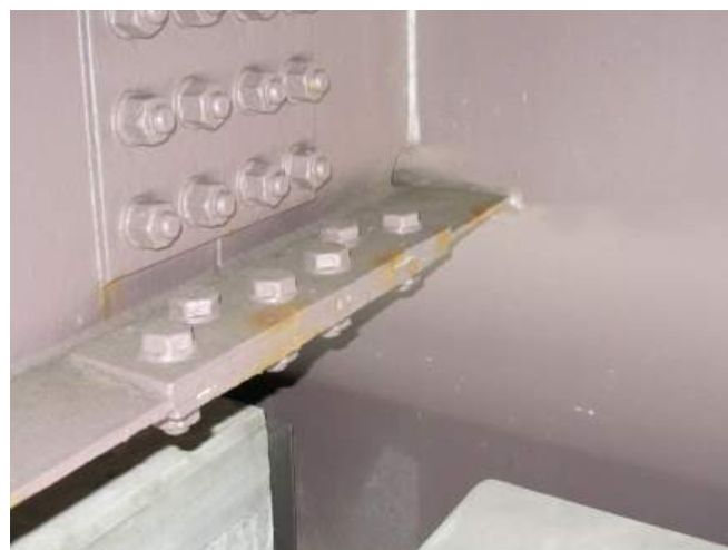
写真-3.2.8 さび発生箇所（エッジ部からのさび）
