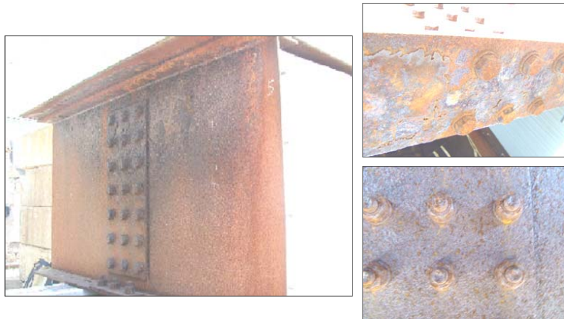
写真－4.3.2 素地調整前の橋梁模擬試験体のさびの状況（JIS 耐候性鋼材） （左：外面側面、右上：下フランジ下面、右下：内面側面）
