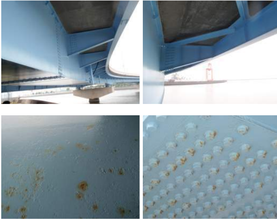
写真-3.2.13 塗替塗装後1～3年経過した塗膜外観
