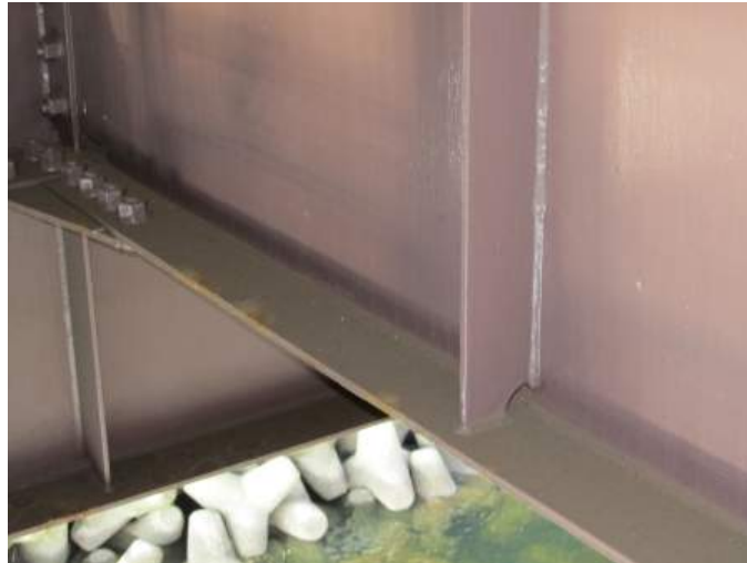
写真-3.2.6 さび発生箇所（足場固定用治具跡からのさび）
