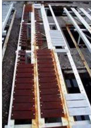
写真-4.1.1 耐候性鋼材の暴露状態
