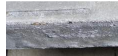
ジンク系塗料での 補修跡
