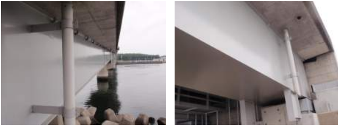
写真-3.2.12 塗替塗装後3年経過した塗膜外観
