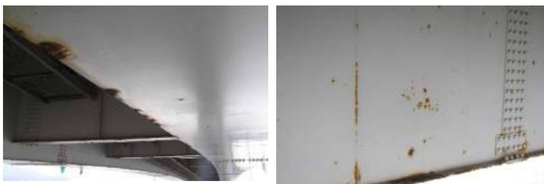
写真-3.2.11 塗替え塗装前の塗膜外観
