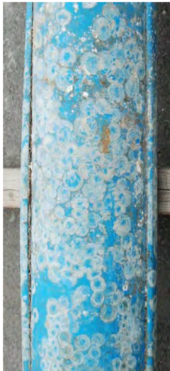
②FRP製当て板の浮き（海生生物の侵入が認められる）
