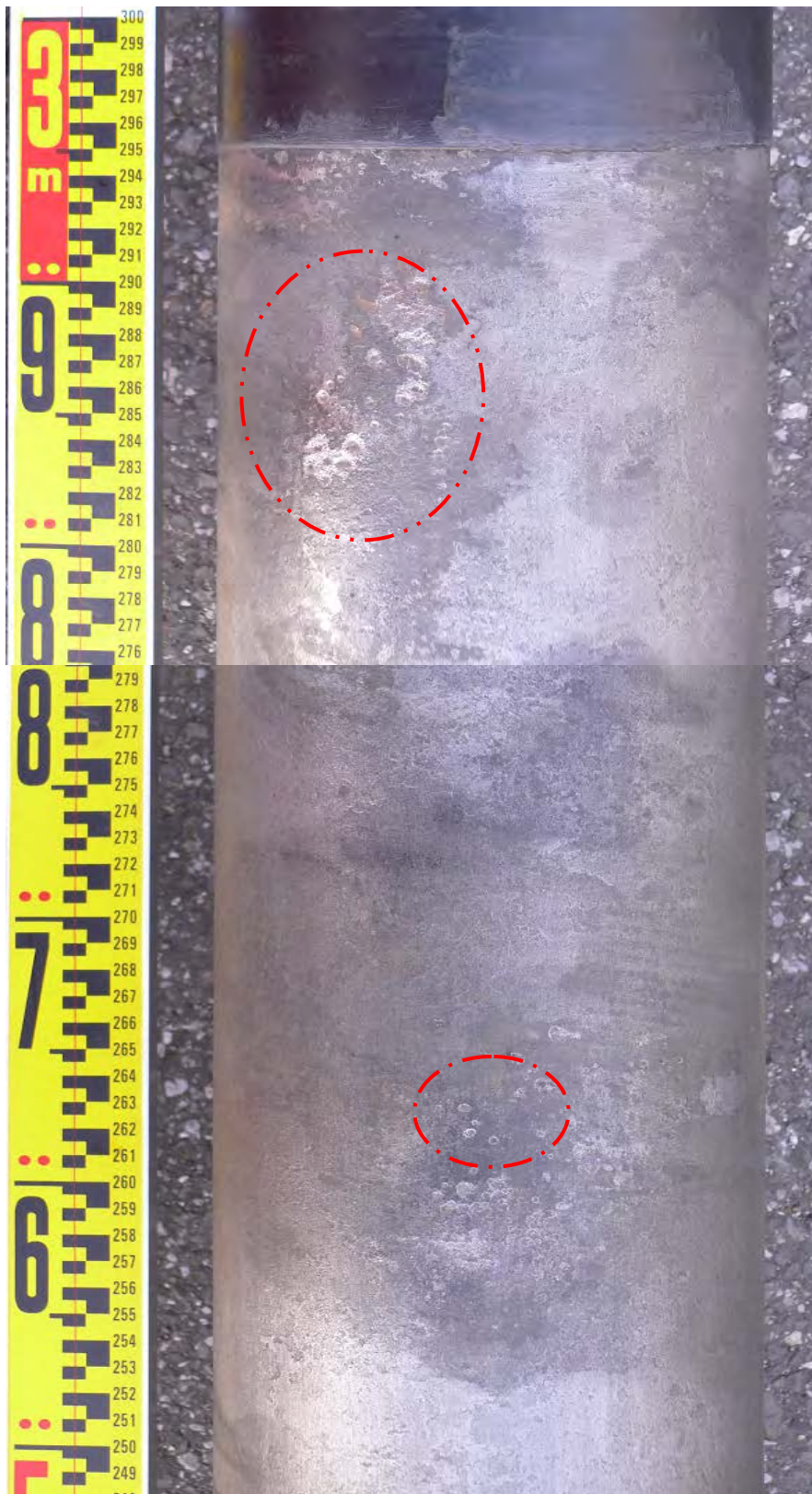
写真-3.3.19.7 溶接仕様チタンカバーの南側上部の腐食箇所
