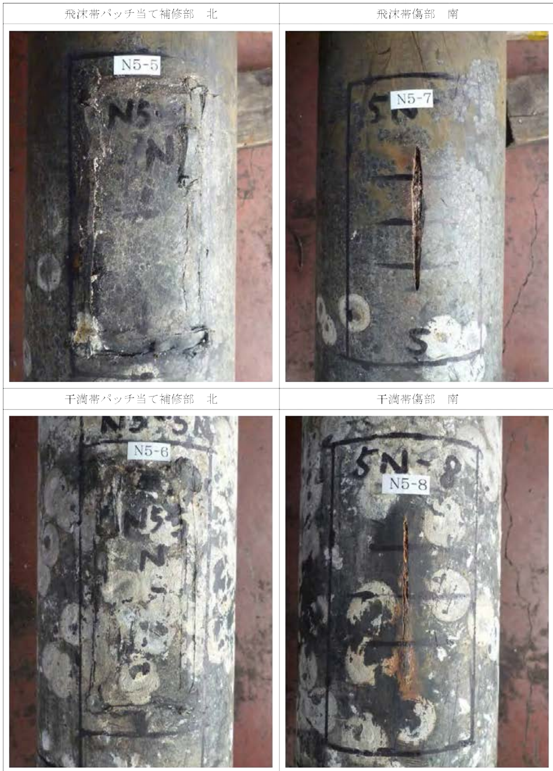
写真-3.3.5.8 N-5 飛沫部・干満部のパッチ当て補修部および人工線状欠陥部の外観
