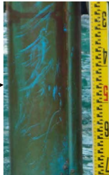
飛沫帯のFRP製保護カバー傷
