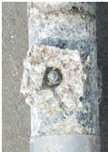
④アルミニウム合金陽極の消耗状況
