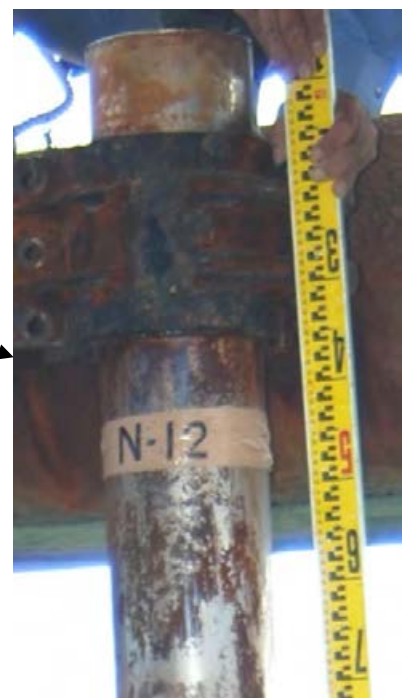
もらい錆状況
