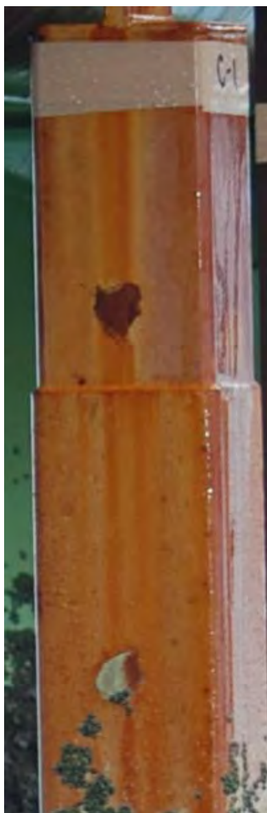
西側面の塗膜はがれ状況
