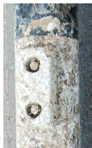
④アルミニウム合金陽極の消耗状況
