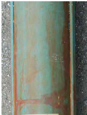
②漂流物の衝突によるあて傷あり
