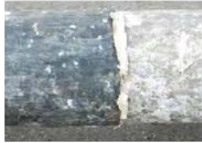
②被覆端部のシーリング材の損傷
