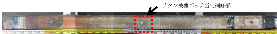
写真-3.3.14.23 T.P.+500 施設側(北)のチタン被覆のパッチ当て補修部の位置
