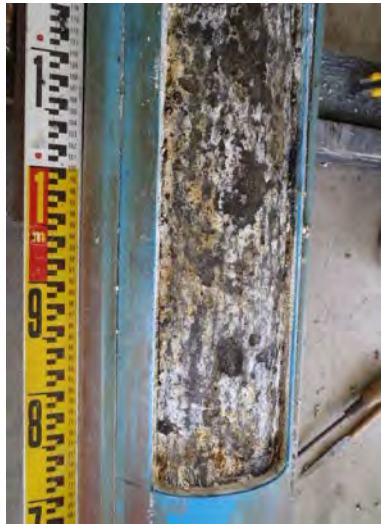
ウレタン系防食樹脂除去後の鋼管素地面状況 (部位①)
