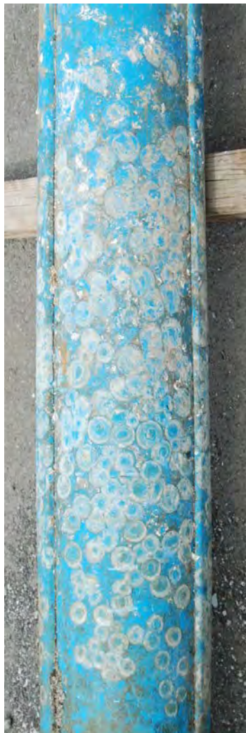
②海生物（フジツボ類）の付着跡（FRP保護カバ―に異状は認められない）
