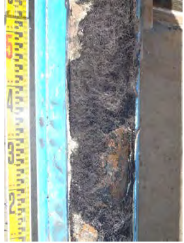
鋼管素地面の外観状況 (部位③)
