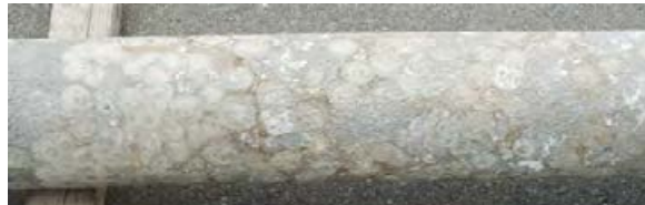
写真-3. 2. 7. 3 試験材 F-2 (東面) 海生生物除去後の外観状況
