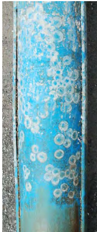
③FRP当て板の浮き（約40cm、海生物の侵入が認められる）
