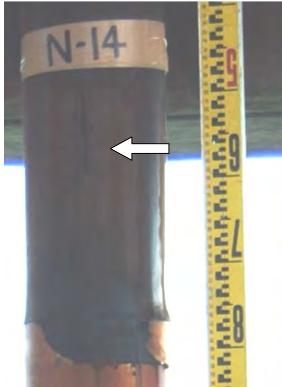
ウレタン部人工傷および ポリウレタン塗膜欠損状況
