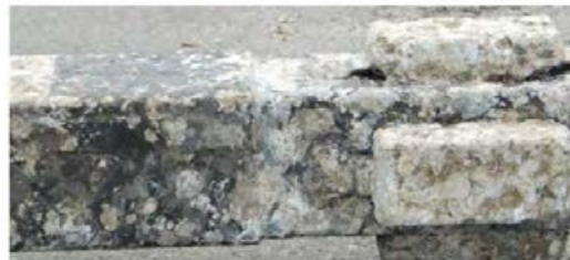
②タールエポキシ塗膜のはがれ
