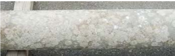
写真-3. 2. 7. 2 試験材 F-2 (西面) 海生生物除去後の外観状況
