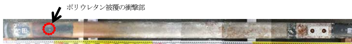
写真-3.3.14.13 T.P.+1800 施設側(南)のポリウレタン被覆の衝撃部の位置
