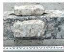
③タールエポキシ塗膜のはがれ
