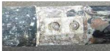
②被覆端部のシーリング材に一部破損が認められる
