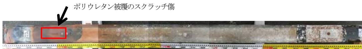
写真-3.3.14.9 T.P.+1800 施設側(北)のウレタン被覆のスクラッチ傷の位置
