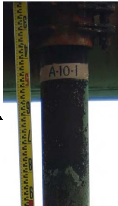
もらい錆の状況
