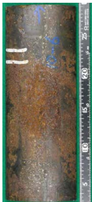
外面/脱スケール前
