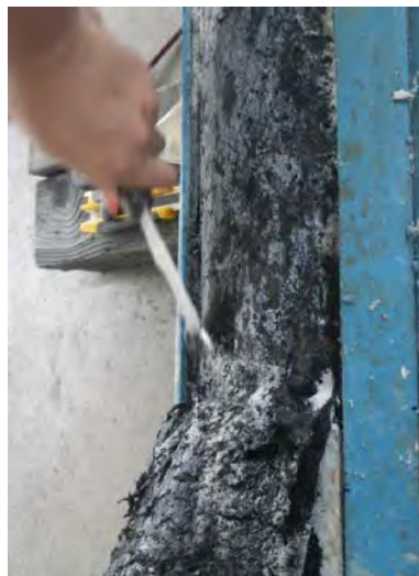
ウレタン系防食樹脂の鋼管素地面への付着状況 (部位①)
