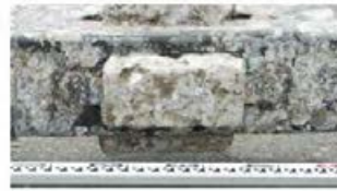
③タールエポキシ塗装部のはがれ
