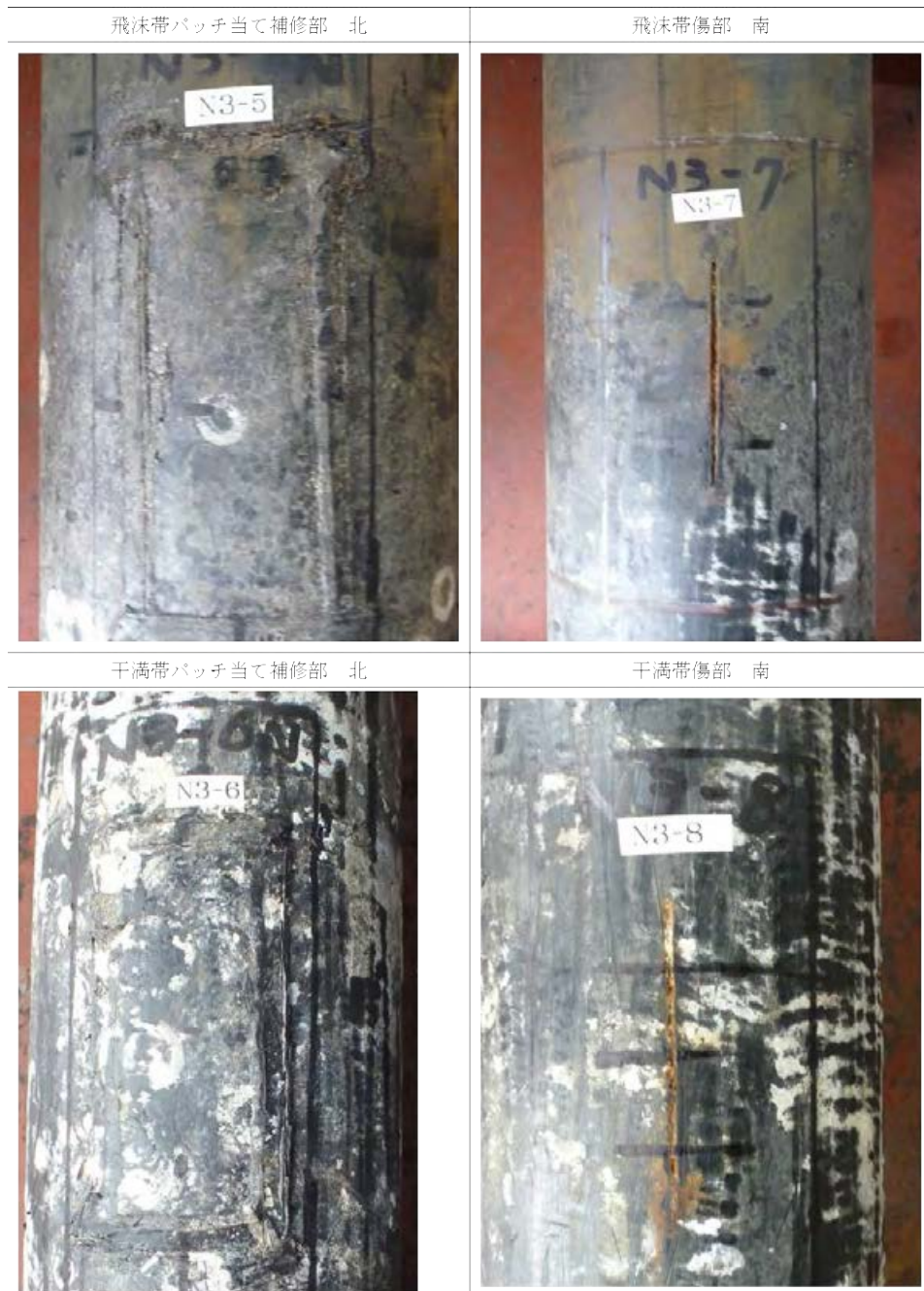
写真-3.3.3.8 N-3 飛沫部・干満部のパッチ当て補修部および人工線状欠陥部の外観
