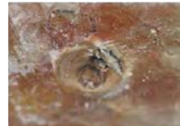
②シール材の機能低下(劣化)によるチタン箔の剥離が認められる(約130mm)
