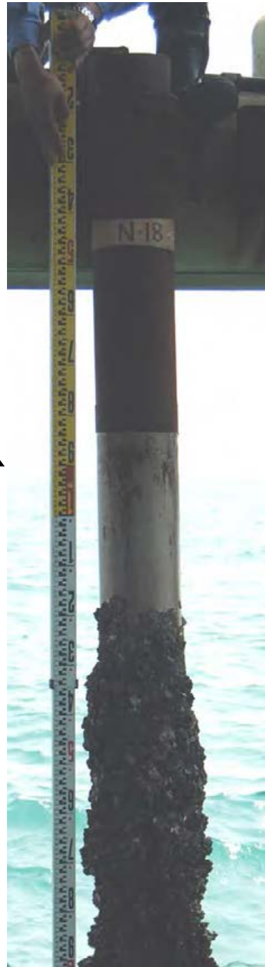
もらい錆および海生生物付着状況
