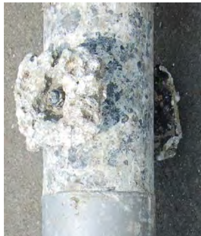
④アルミニウム合金陽極の消耗状況
