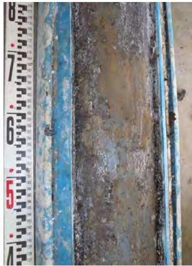
ウレタン系防食樹脂除去後の鋼管素地面状況 (部位②)
