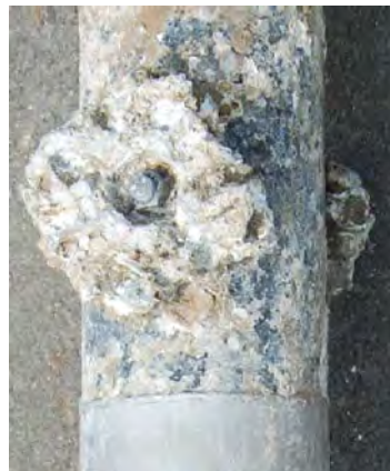
④アルミニウム合金陽極の消耗状況
