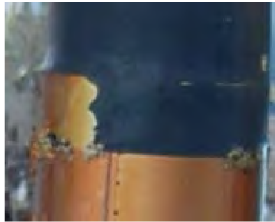
ポリウレタン被覆部の欠損状況
