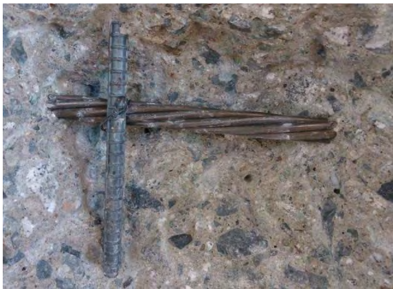
写真-4.5.3 腐食状況（試験体 C029）
