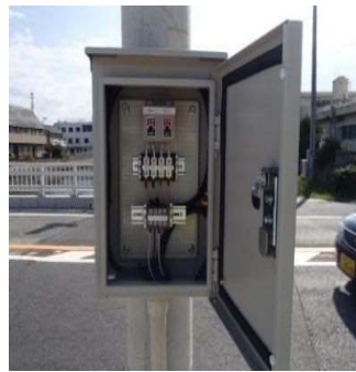
写真-4.4.2 流電陽極方式モニタリング装置
