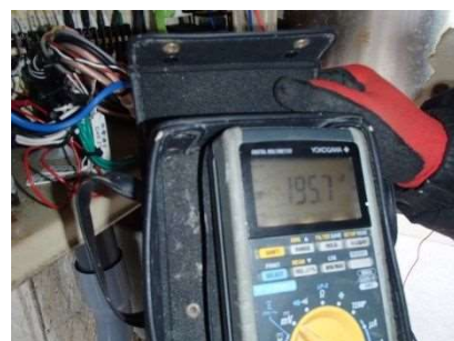
写真 4.2 電位値不安定 (195.7mV)
