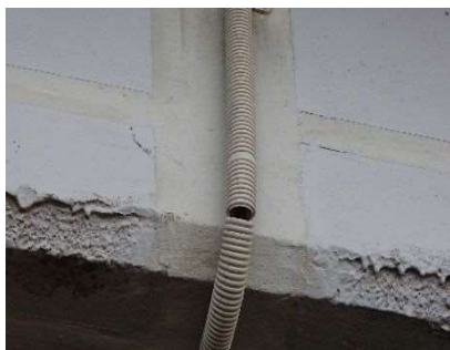
写真 1.7 配管材の割れ
