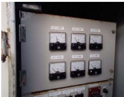
写真 1.3 箱体内部の腐食
