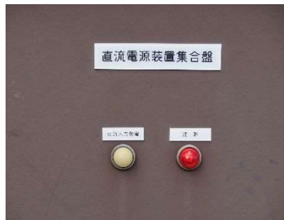
写真 1.4 受電/運転ランプの色褪せ
