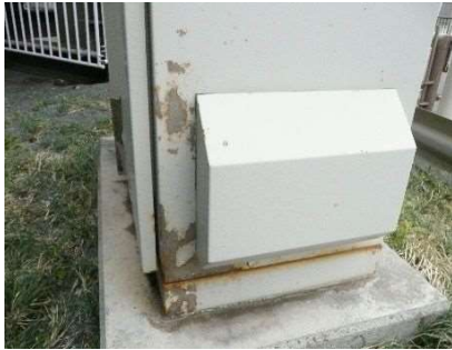
写真 1.1 箱体塗装の剥がれ
