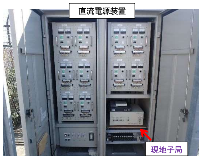
写真-1 現地子局の外観
