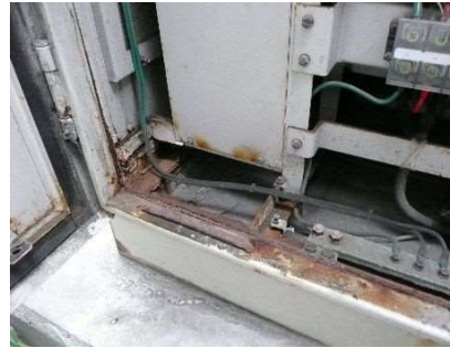
写真 1.2 箱体外部の腐食
