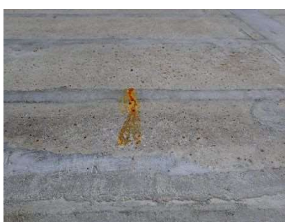
写真 1.10 被覆モルタルからの錆汁 (チタンリボンメッシュ方式)
