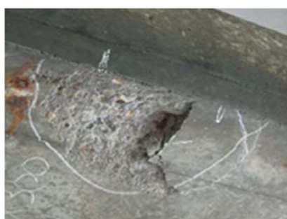
写真 1.14 コンクリートの剥落 (チタンロッド方式)
