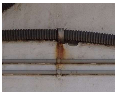
写真 1.9 配管固定金具からの錆汁
