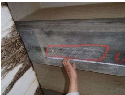
写真 3.1 被覆モルタル浮き部
