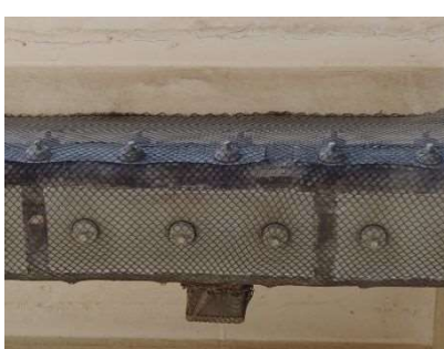
写真 1.13 防食板の変形 (流電陽極方式：垂鉛シート方式)
