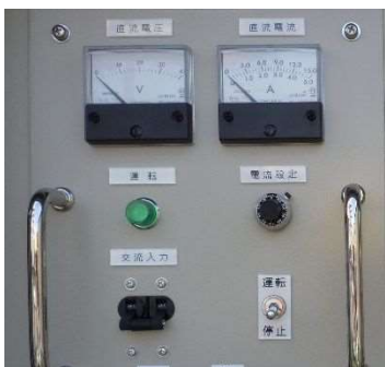
c) 扉内部にランプ・メータあり
