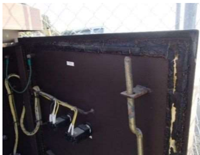
写真 1.5 ゴムパッキンの劣化
