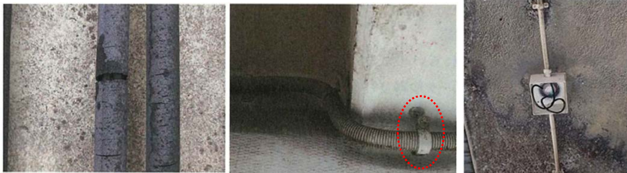
a)配線保護材の割れの例
