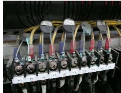
写真 1.6 端子の劣化・腐食
