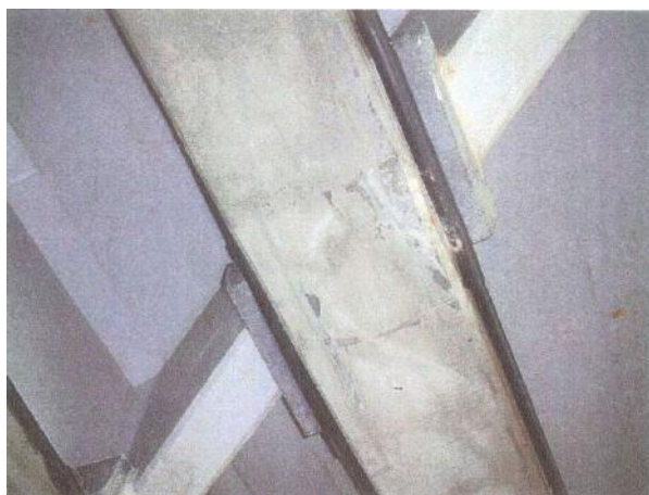
写真-2.1.2 仕上げ材のはく離 (スパン2 G5 桁)
