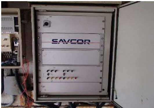
写真-3.2.3 チタングリッド方式 (直流電源装置)
