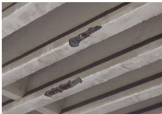
写真-4.5.4 主桁の変状（他径間）
