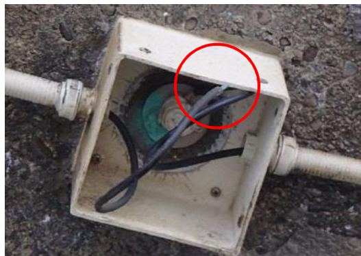
写真-3.5.12 陽極ケーブル外れ
