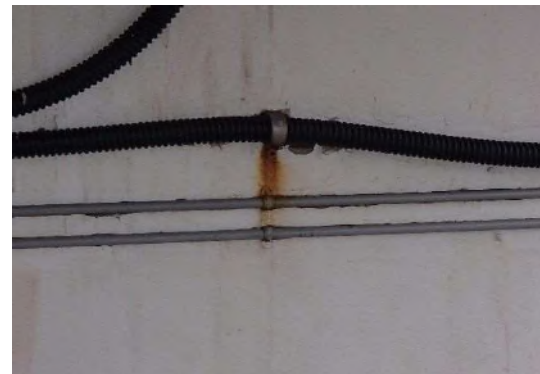
写真-3.3.4 流電陽極方式 (SUS製金具からの錆汁)
