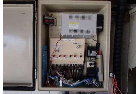
写真-3.2.2 チタンメッシュ方式 (直流電源装置)
