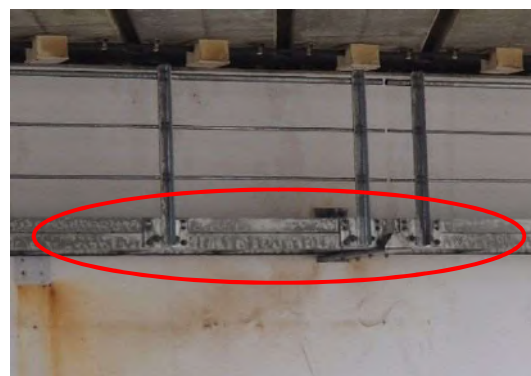
写真-3.5.2 点検足場への塩分付着
