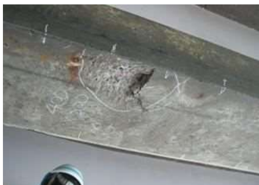
写真-4.1.1 G3桁の変状部
