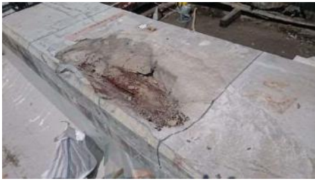
No.001 の赤囲み部分を ハンマーでたたき落とした状況。
