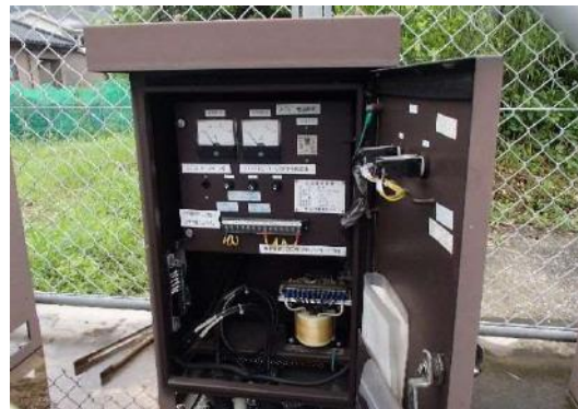
写真-5.5.5 直流電源装置（内部）
