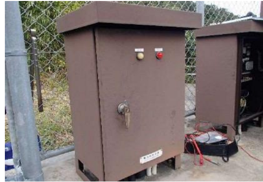
写真-3.2.2 直流電源装置箱体
