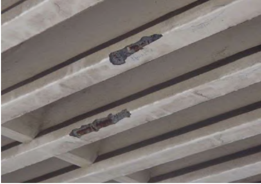
写真-5.1 電気防食非適用部の劣化
