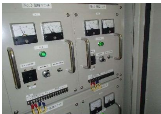
写真-3.5.9 直流電源装置計器盤
