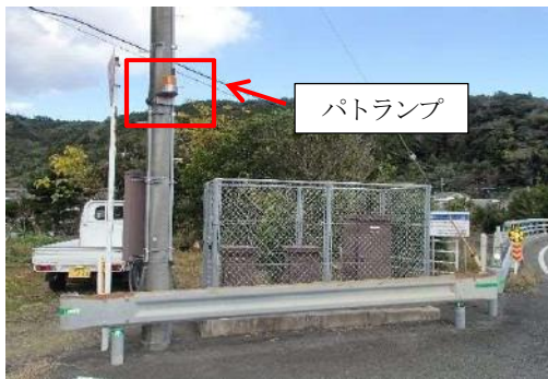
写真-3.3.10 パトランプ設置例
