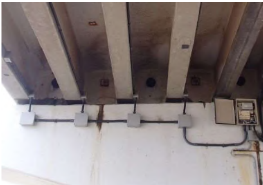
写真-3.9.1 チタンメッシュ方式 配線分配状況 (P7橋脚側面)
