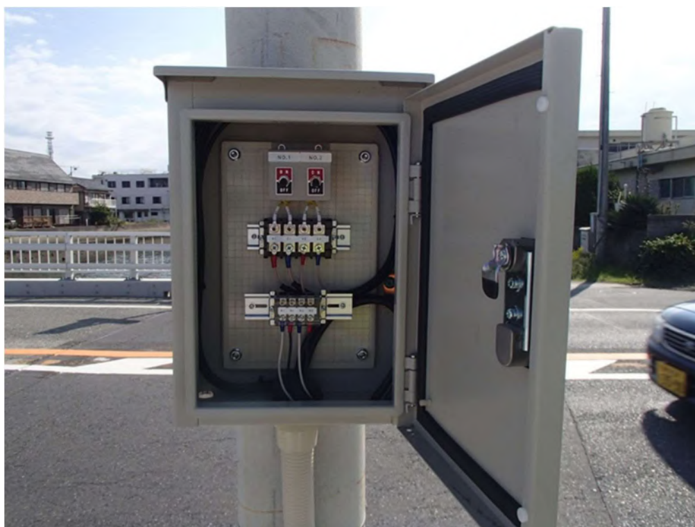
写真-3.3.29 流電陽極方式モニタリングボックス (ナカボーテック)
