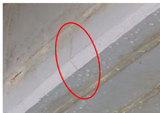
写真-5.5.2 P1-A2 G4 桁 ひび割れ
