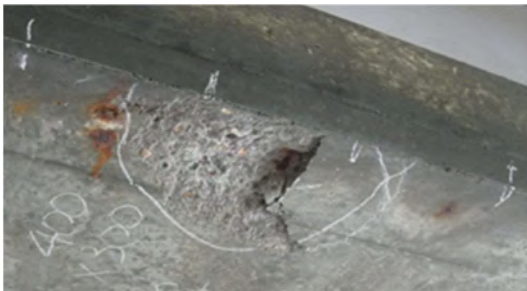
写真-6.2.1 底面部の剥落箇所 (G3桁)
