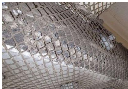
写真-3.1.4 G9桁パテ剥落部
