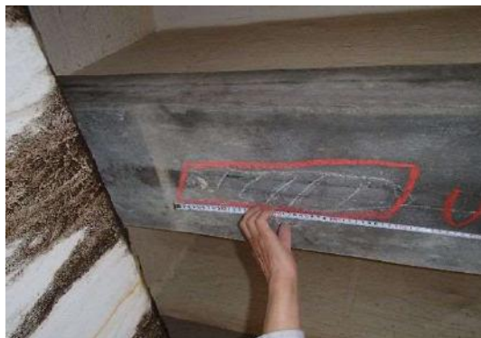
写真-3.1.3 G5桁被覆モルタル浮き部
