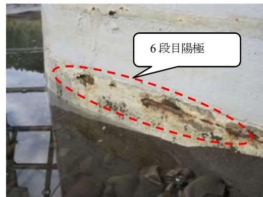
写真-3.5.1 橋脚下部没水状況
