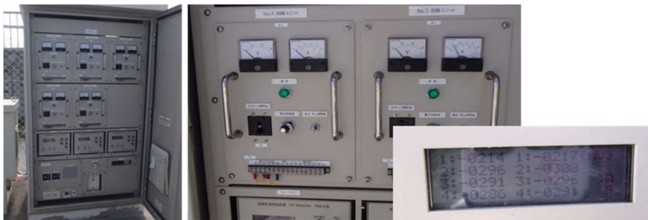
写真-4.4.1 【定電流方式】（遠隔監視システム付加）
