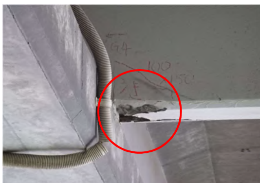
写真-1.5.5 横桁の変状部 (スパン 2 G4 桁)
