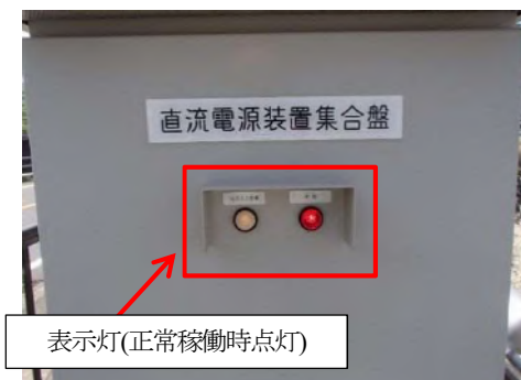
写真-3.3.1 装置外部表示灯例
