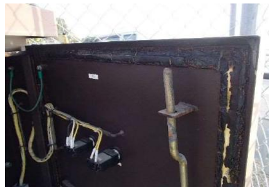
写真-3.2.4 ゴムパッキンの劣化
