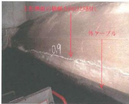
写真 - 6.6.7 G5 桁側面のひび割れ
