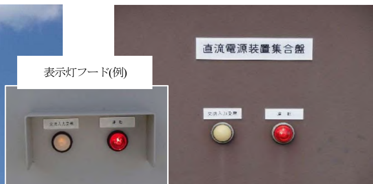
写真-3.2.6 受電ランプ／運転ランプ
