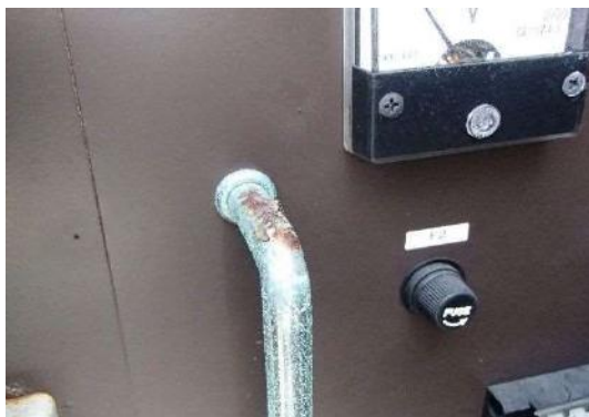
写真-3.2.3 金属部の腐食
