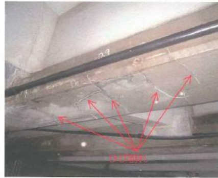
写真 - 6.6.8 G5 桁下面のひび割れ
