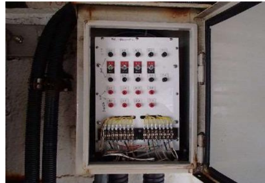
写真-3.2.4 流電陽極方式 (モニタリングボックス)
