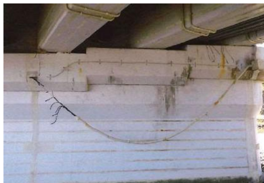
写真-5.5.8 P1 橋脚部配管材の脱落（定期点検資料より）
