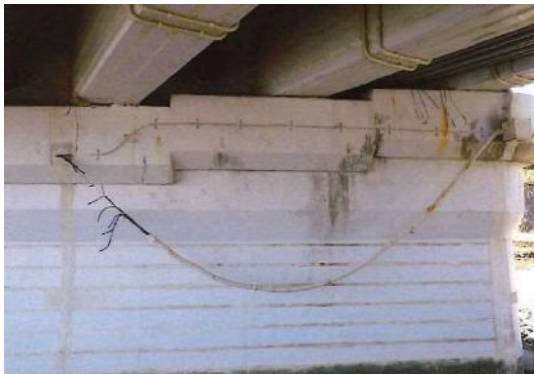
写真-5.1 A1側配管材の脱落
