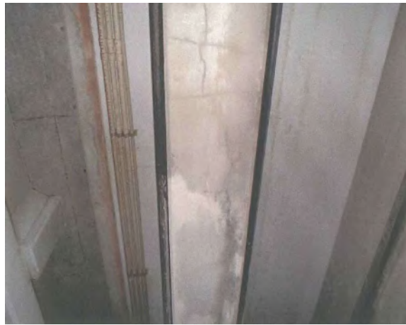
写真-2.1.6 桁下のひび割れ (スパン2 G6桁)
