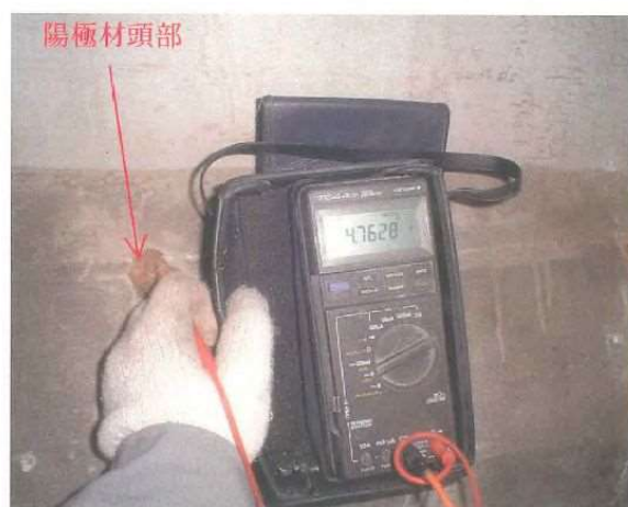
写真 - 6.6.6 電圧確認（正常値）
