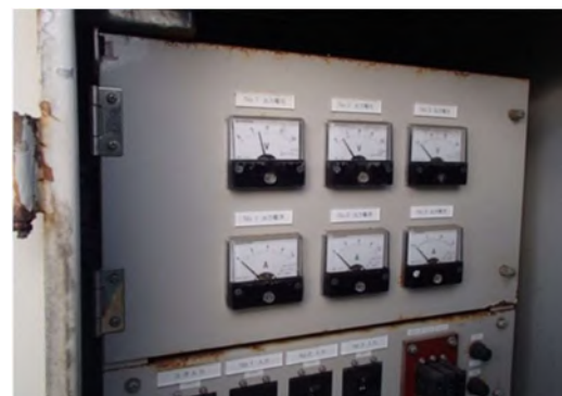
写真-3.3.4 箱体の腐食例
