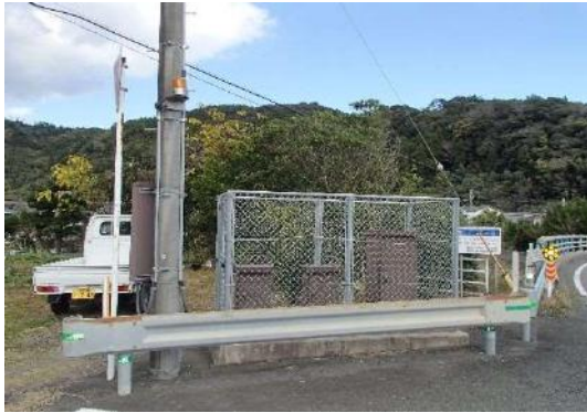
写真-3.2.1 直流電源装置全景
