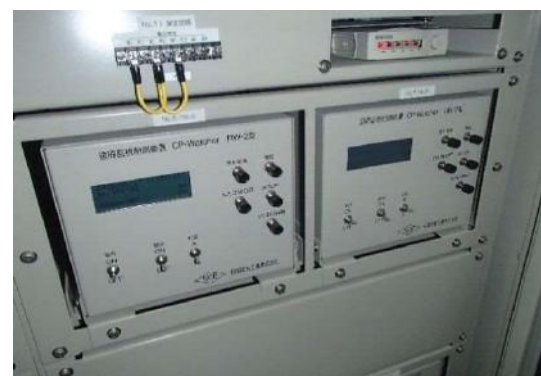
写真-3.5.10 遠隔モニタリングシステム
