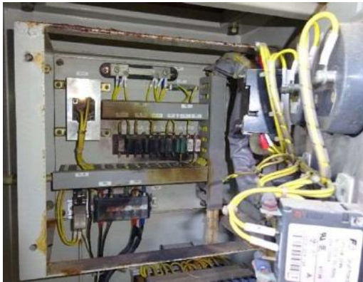
写真-4.4.10 落雷による損傷例
