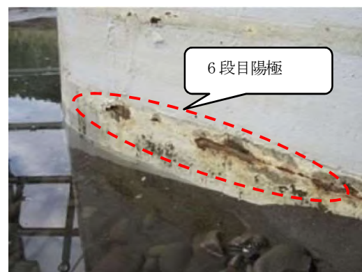
写真-8.2.1 橋脚下部没水状況
