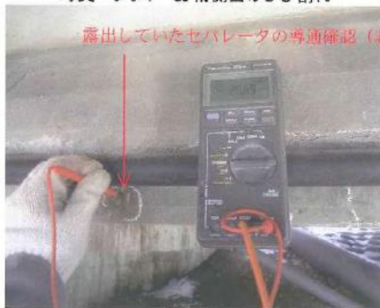
写真 - 6.6.9 G5 桁の非導通金属(腐食)
