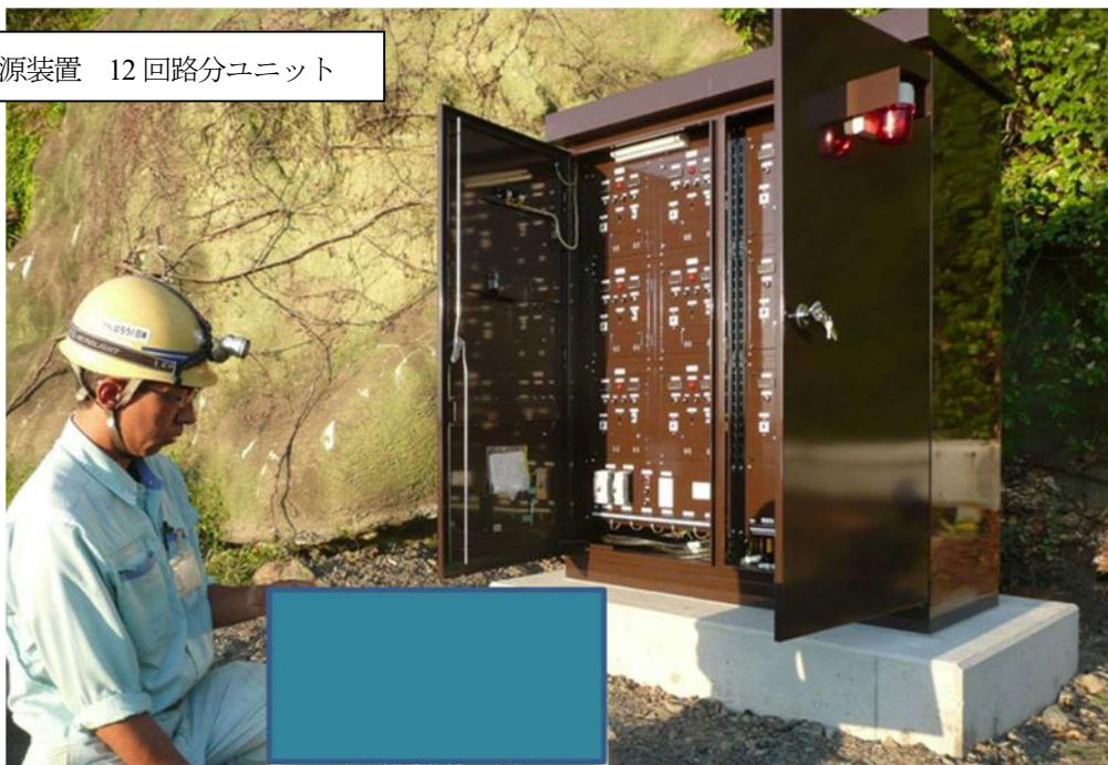
定電流制御方式 直流電源装置
