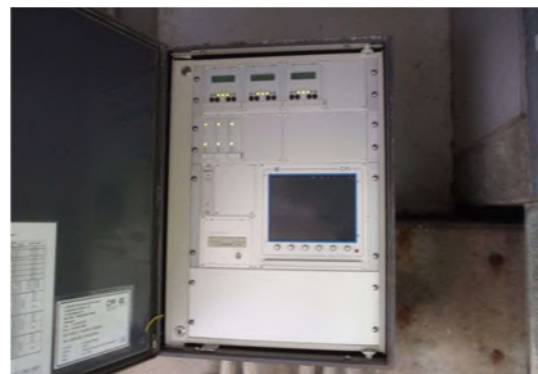
写真-1.5.2 直流電源装置の状況
