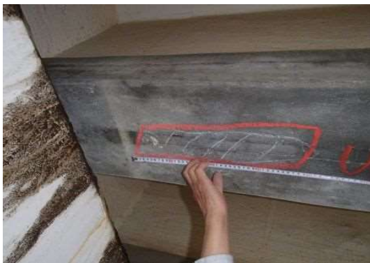
写真-4.1.1 被覆モルタル浮き部
