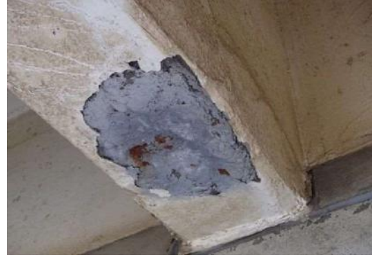
写真-5.2 非適用部の劣化（電気防食径間内）
