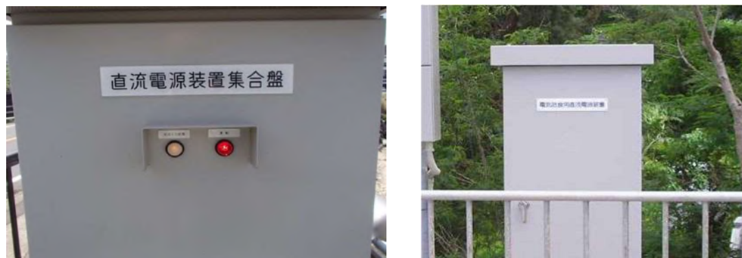
写真-4.4.4 受電および運転表示ランプ（その1）
