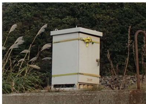
写真-3.3.3 箱体の損傷例
