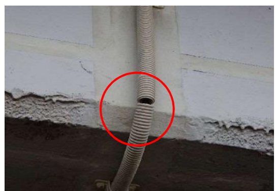
写真-3.3.4 配管材の割れ
