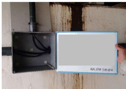
写真-3.4.4 橋脚部プルボックス
