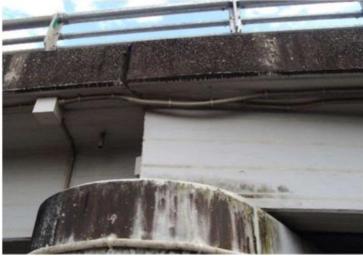
写真-3.3.5 配管材の脱落
