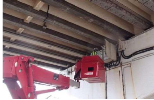
写真-4.4.9 海岸沿い高所への設置例
