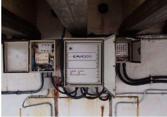
写真-3.2.1 直流電源装置・モニタリングボックス
