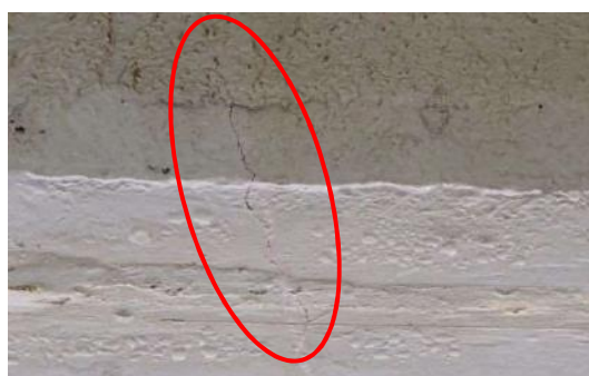
写真-3.1.2 G2 桁底面のひび割れ
