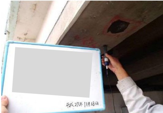
写真-3.7.1 チタンメッシュG1桁剥落部測定状況
