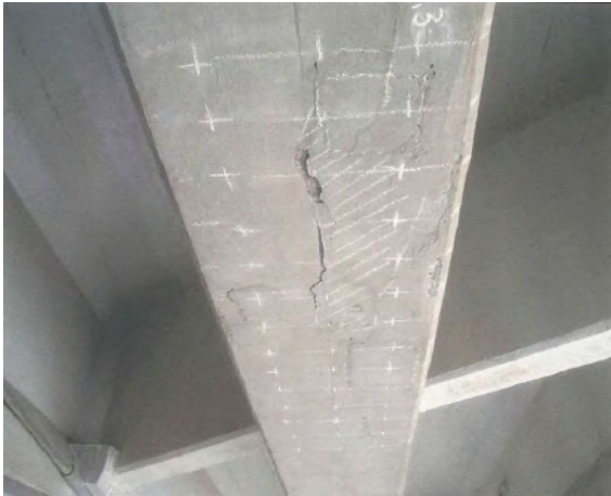
写真-2.1.4 下フランジ下面のひび割れ (スパン2 G2桁)
