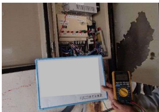
写真-3.5.1 外部電源方式測定状況
