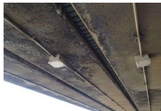
写真-3.5.8 チタン溶射方式 (溶射被膜の剥がれ)
