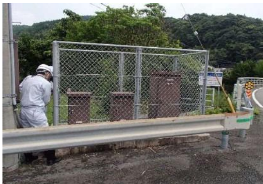
写真-5.5.4 直流電源装置（全景）
