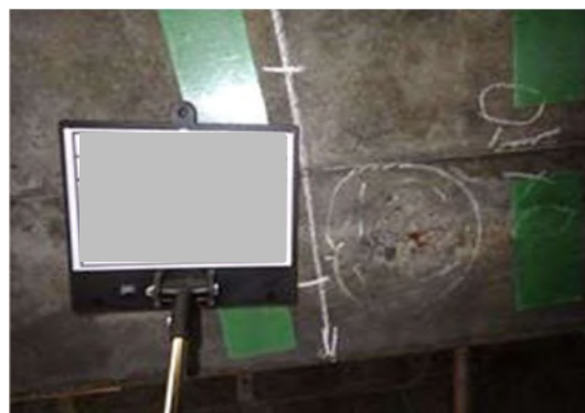
写真-3.1.2 G4 桁被覆モルタル剥落部
