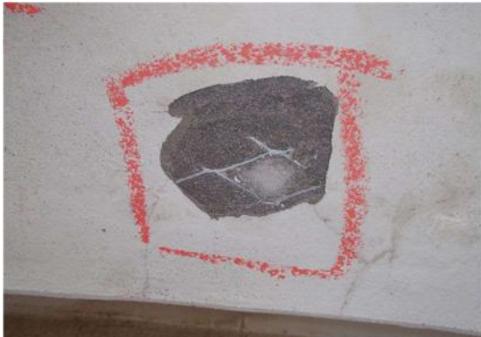
写真-3.1.1 G1桁被覆モルタル剥落部
