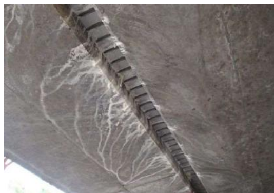
写真-3.5.1 桁間詰部からの析出物
