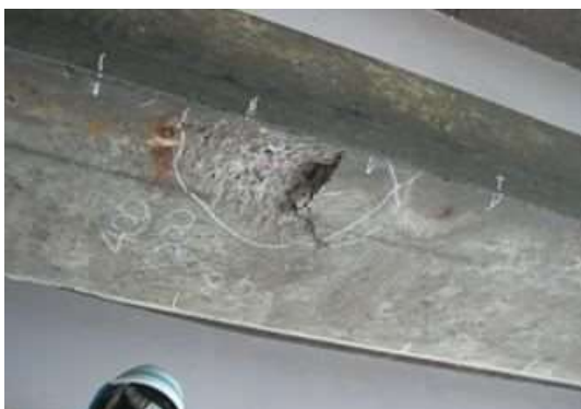
写真-3.1.1 G3 桁の変状部
