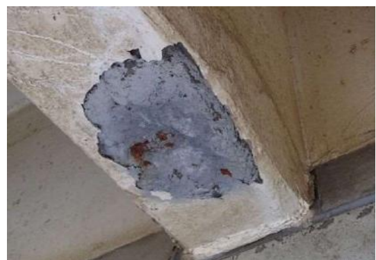
写真-4.5.5 横桁の変状（同径間）
