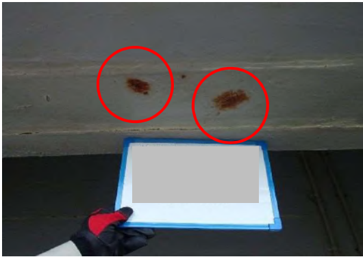
写真-3.1.9 G1 桁底面の変色
