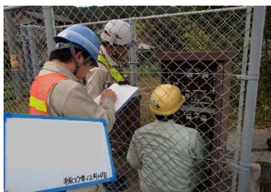
写真-3.6.1 直流電源装置での測定状況
