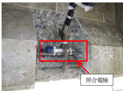
写真-3.3.7 鉛照合電極設置例
