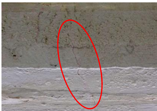
写真-5.5.1 A1-P1 G2 桁 ひび割れ
