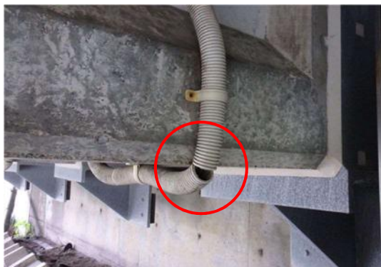
写真-1.5.3 配線配管の状況
