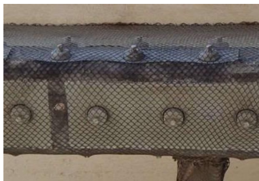
写真-3.1.5 流電防食板波打ち状況
