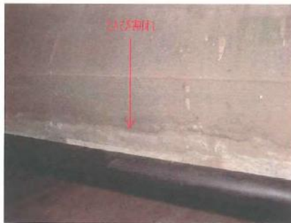
写真 - 6.6.10 防食前の2000年5月撮影
