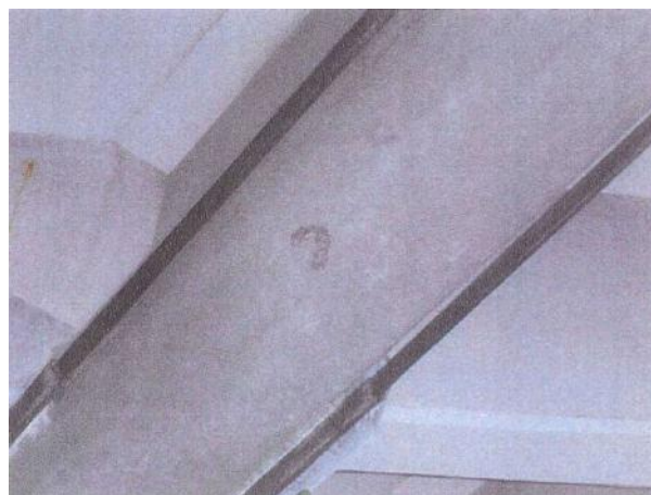
写真-2.1.3 はく離 (スパン2 G2 桁)
