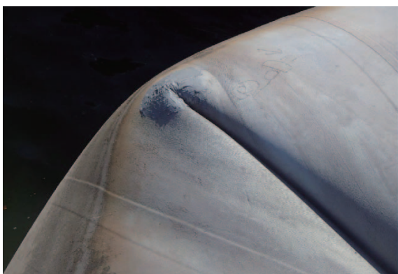
写真 2.1.13 法部折れシワ部のひび割れ
