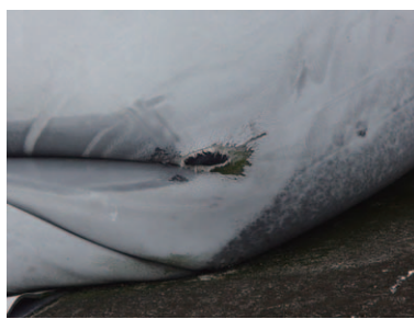
写真2.1.20 ゴム・補強繊維の劣化亀裂
