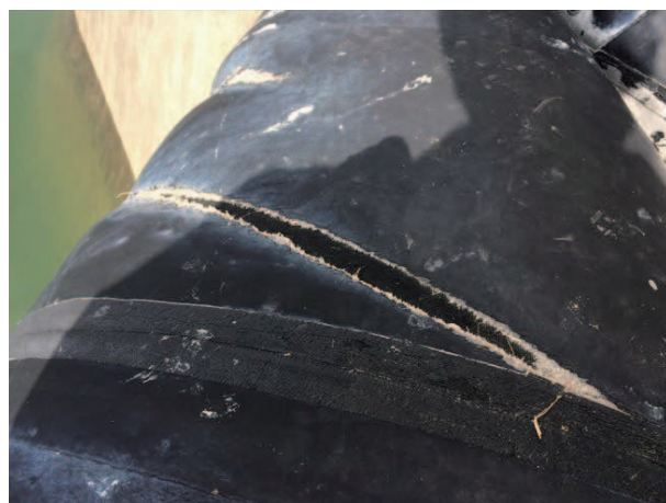
写真 2.2.23 織布破断したゴム袋体
