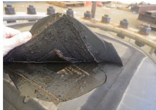
写真 3.2.20 補修部剥がれの状態
