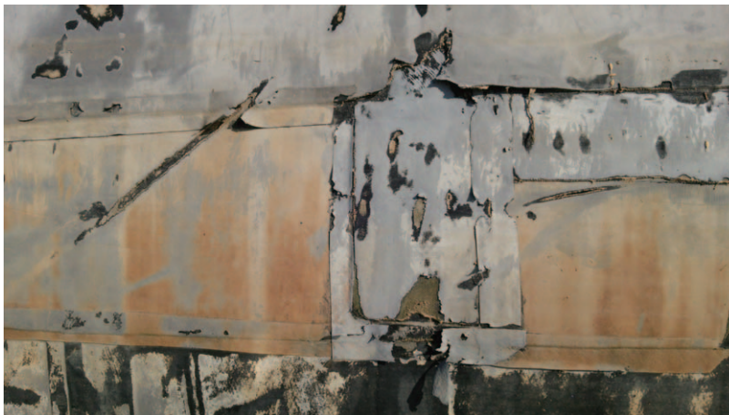
写真 2.1.1 転石摩耗による劣化状態
