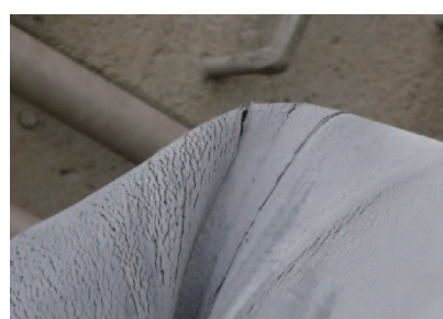
写真2.1.21 ゴムの劣化亀裂(法部)
