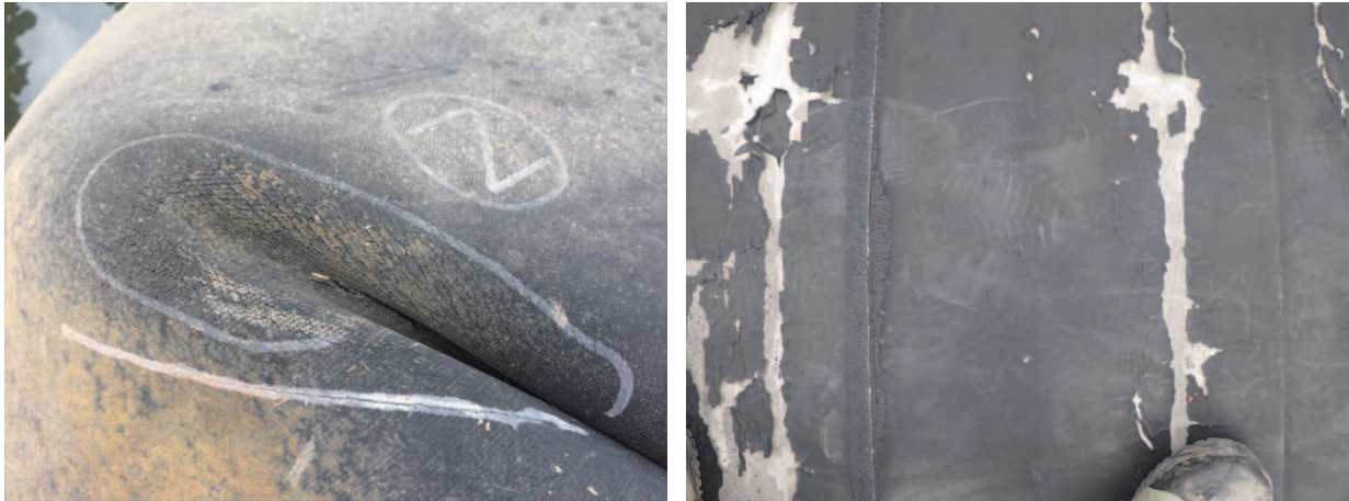
写真2.2.24 局部応力を受けたカバーゴムのひび割れ 写真2.2.25 カバーゴムがはく離し、織布露出したゴム袋体
