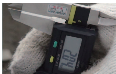
写真2.1.23 亀裂深さ ; 2mm
