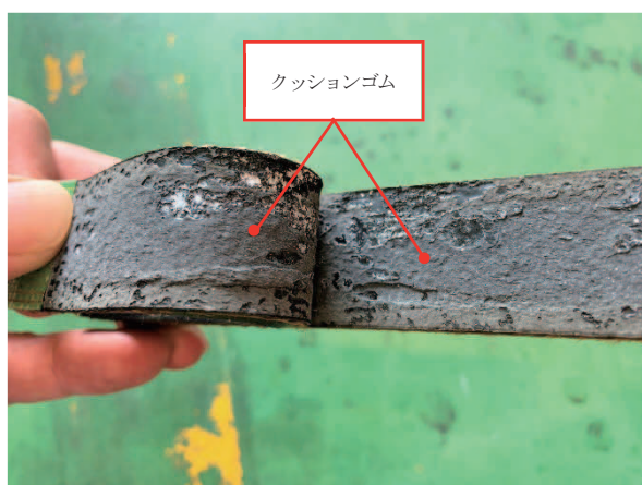
写真 3.2.17 凝集破壊の例
