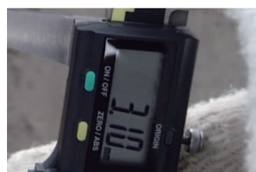
写真2.1.24 亀裂深さ ; 3.1mm
