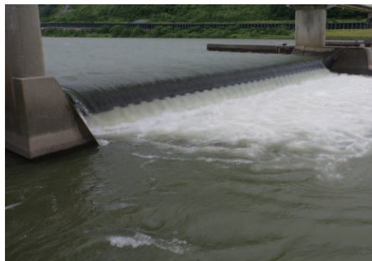
写真 2.1.10 堰体振動した堰の例
