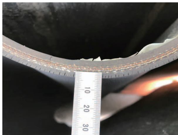
写真 2.2.21 深さ方向に進行したひび割れ
