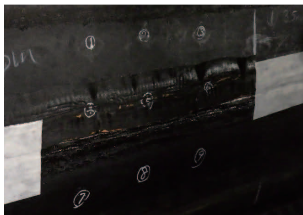
写真 3.1.6 内部側面内面はく離部外観
