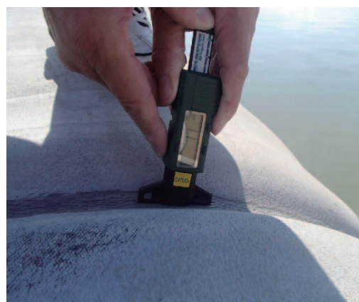
写真 2.1.16 同左（ひび割れ深さ=1.1mm）
