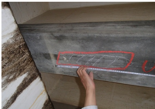
写真-4.4.1 被覆モルタル浮き部
