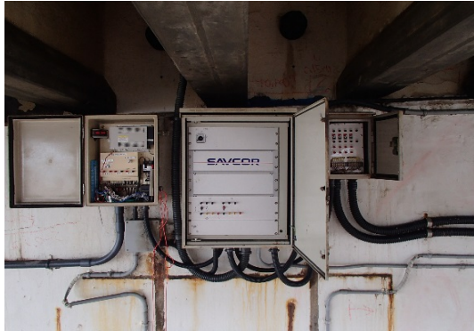
写真-3.3.7 直流電源装置・モニタリングボックス
