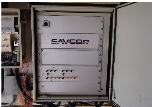
写真-3.3.9 チタングリッド方式 (直流電源装置)
