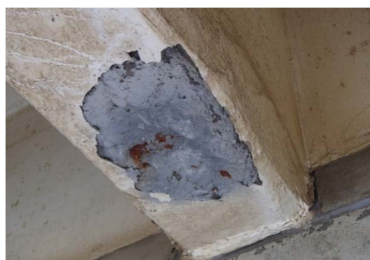
写真-2.5.5 横桁の変状 (同径間)
