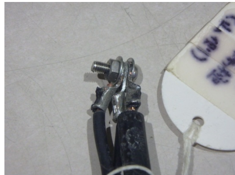
写真-5.5.5.4 結線部詳細 G10-3 回路
