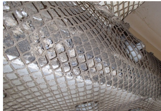
写真-3.3.4 G9桁パテ剥落部
