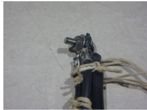
写真-5.5.5.6 結線部詳細 G11-3 回路
