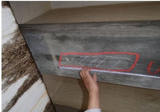
写真-3.3.3 G5桁被覆モルタル浮き部
