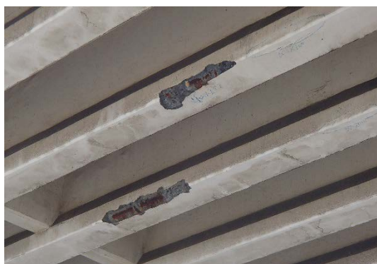
写真-2.5.4 主桁の変状 (他径間)
