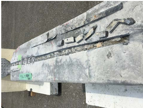
写真-5.4.4.3 ブロック⑨ (新潟側)
