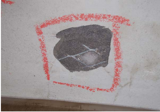
写真-3.3.1 G1桁被覆モルタル剥落部
