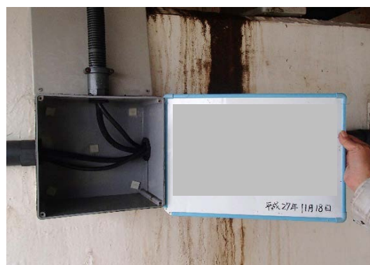
写真-3.3.18 橋脚部プルボックス
