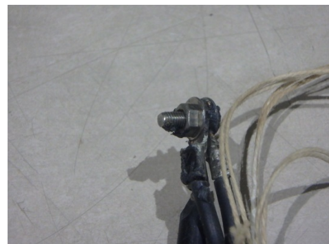
写真-5.5.5.10 結線部詳細 G11-4 回路
