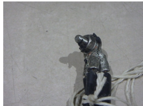
写真-5.5.5.8 結線部詳細 G10-4 回路
