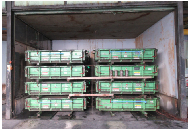
図 2-7 フリーム試験体を用いた実験における蒸気養生設備の正面写真
