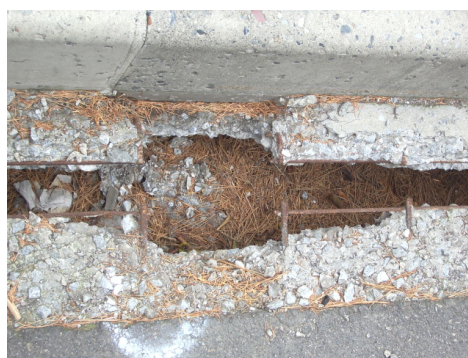
図 1-1 DEFによって劣化した側溝の事例 8)
