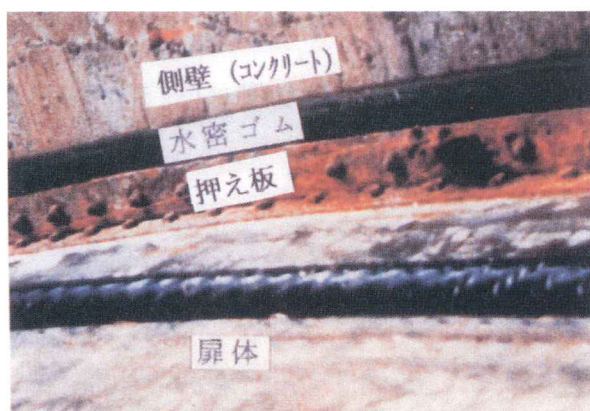
写真解-5.2 水密ゴム押え板(常時水中部)の腐食例
