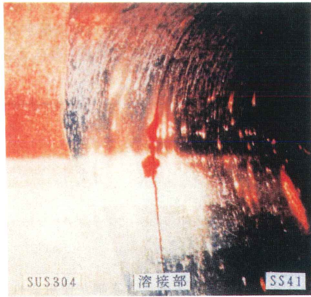
写真解－5.6 鋼製起伏ゲートの塗装面の局所的な錆の例
