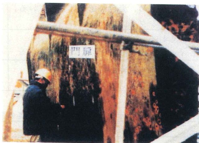
写真解-5.7 鋼製起伏ゲートの塗装面の局所的な錆、ふくれの例
