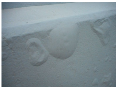
a) 浮き, 膨れ
