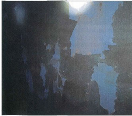
解説 写真-3.1.2 結露が要因となり発生した塗膜の剥離
