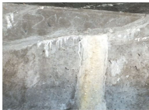
ひび割れ充填後（約1年後）の析出物
