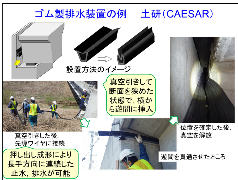
解説 図-2.3.2 橋梁の桁端における樋の設置（資料提供：土木研究所 CAESAR）
