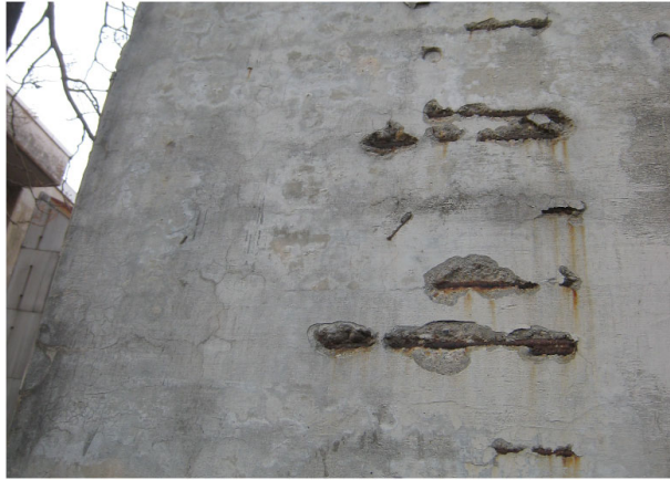
解説 写真-2.2.2 かぶりの薄い箇所における中性化による劣化事例
