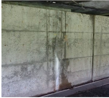
解説 写真－3.1.1 ひび割れ修復工法の施工後に発生した変状の例
