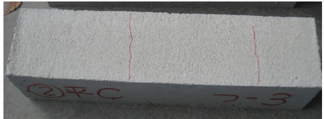
(3) 暴露3年でのひび割れの状況
