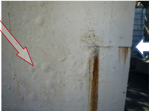
断面修復部とコンクリートの境界に沿って、ひび割れと漏水跡、その延長上に局所的な膨れが発生
