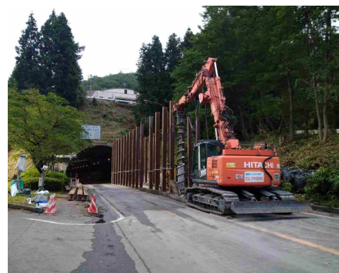
国道19号の対策(長野国道)
