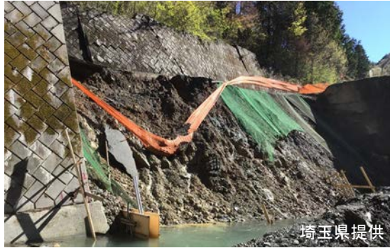
現地の状況 (護岸被災箇所)
