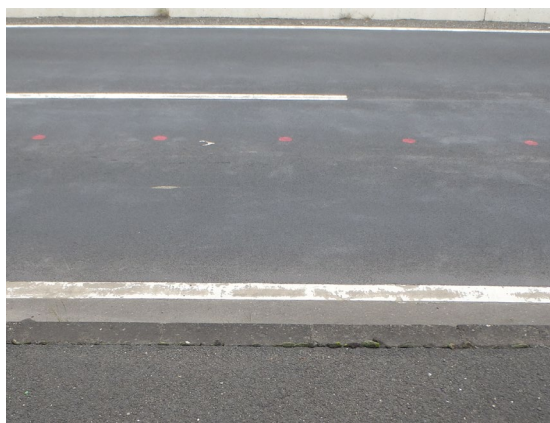
(b) 大平高架橋のマーキング
