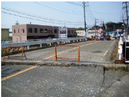
写真-4.4.23.2 橋台背面部の段差 (左岸側)
