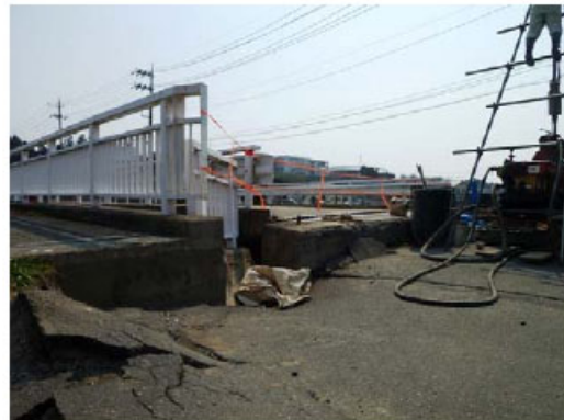
写真-4.4.23.3 橋台背面部の段差 (右岸側)
