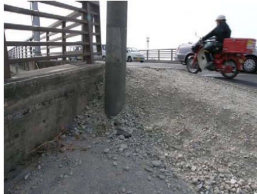
写真-4.2.10.6 橋台背面段差(左岸 A2 側)
