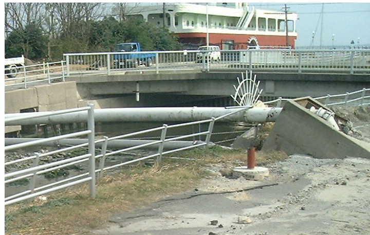
図-6.1.12 被害した対象橋梁及び周辺の様子
