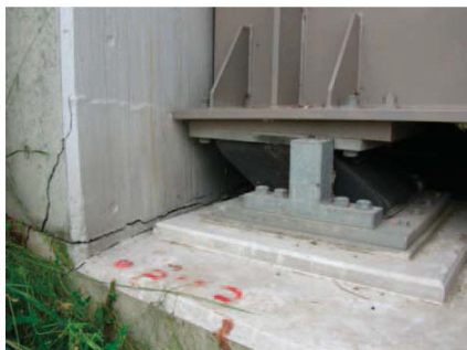
図-6.1.16 支承の残留変位とパラペット基部のひび割れ
