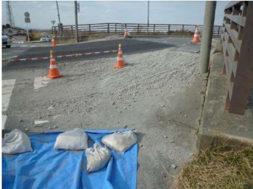
写真-4.2.10.5 橋台背面段差(右岸 A1 側)
