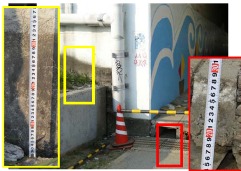
図-6.1.21 A1 橋台と護岸、A1 橋台と一般部の鉛直変位差 (30cm)
