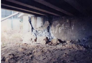
④ 縦壁の損傷(せん断破壊)
