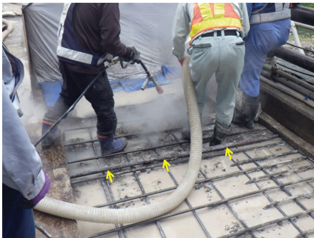
図-A1.4 A1-P1 間の RC 床版の貫通ひび割れ箇所に埋設されていた照明用電線管
