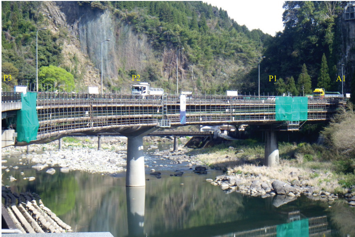
(e) A1-P3 間 (A2 側から撮影, 2019 年調査時)
