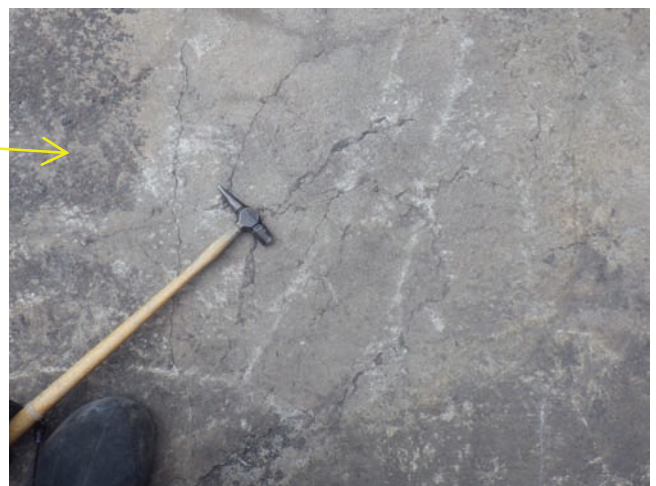
(e) センターライン付近の浮きとひび割れ
