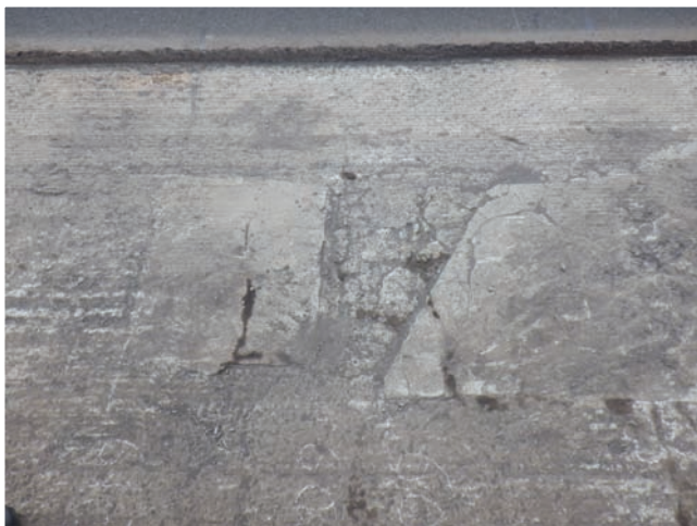
(c) 床版上面，損傷部（図(b)の破線部の拡大）
