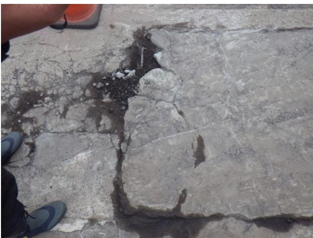
(c) 床版上面，損傷部，鉄筋露出 拡大
