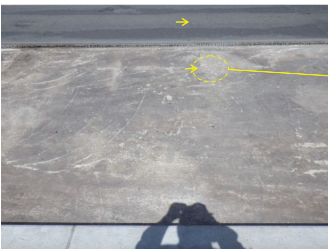
(d) 貫通ひび割れ (下り側舗装除去時)
