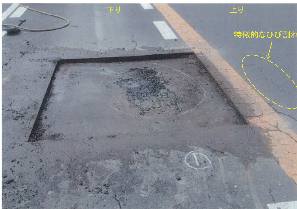
(b) 補修直前の床版上面, 2015年9月
