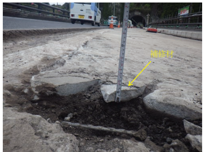
(d) 床版上面，損傷部，補修材の下
