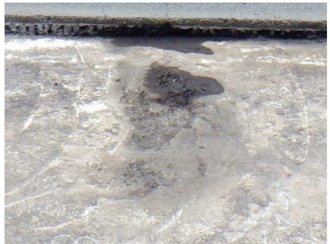
(c) 貫通ひび割れ, センターライン付近の拡大
