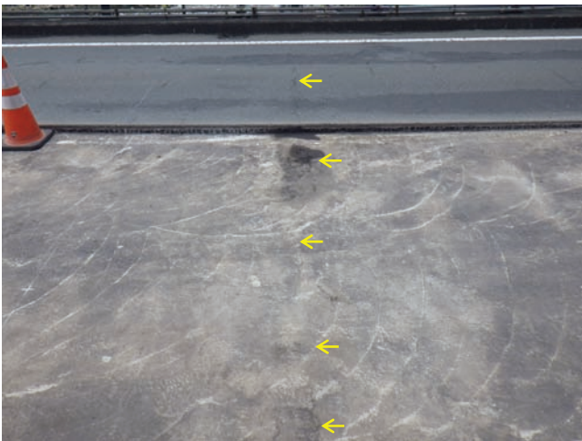
(b) 貫通ひび割れ (下り側舗装除去時)
