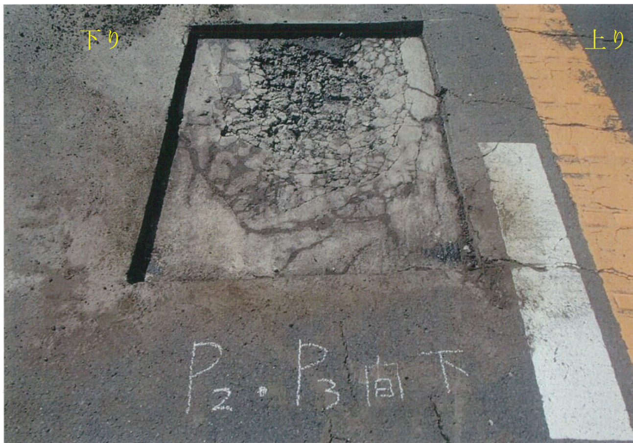
図-2.3.1 2014 年補修時の床版上面の劣化状況（第 3 径間，下り）
