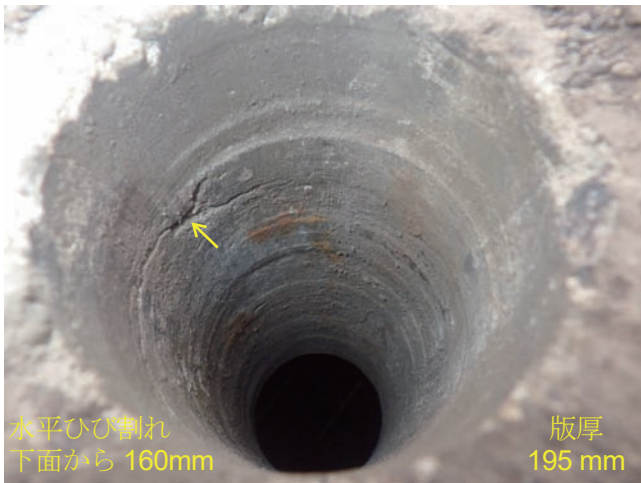
図-4.1.18 P1-P2 間床版の貫通孔
