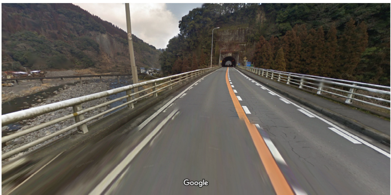
図-5.4.1 A1-P1 間, プレートガーダー区間の路面ひび割れ 11)
