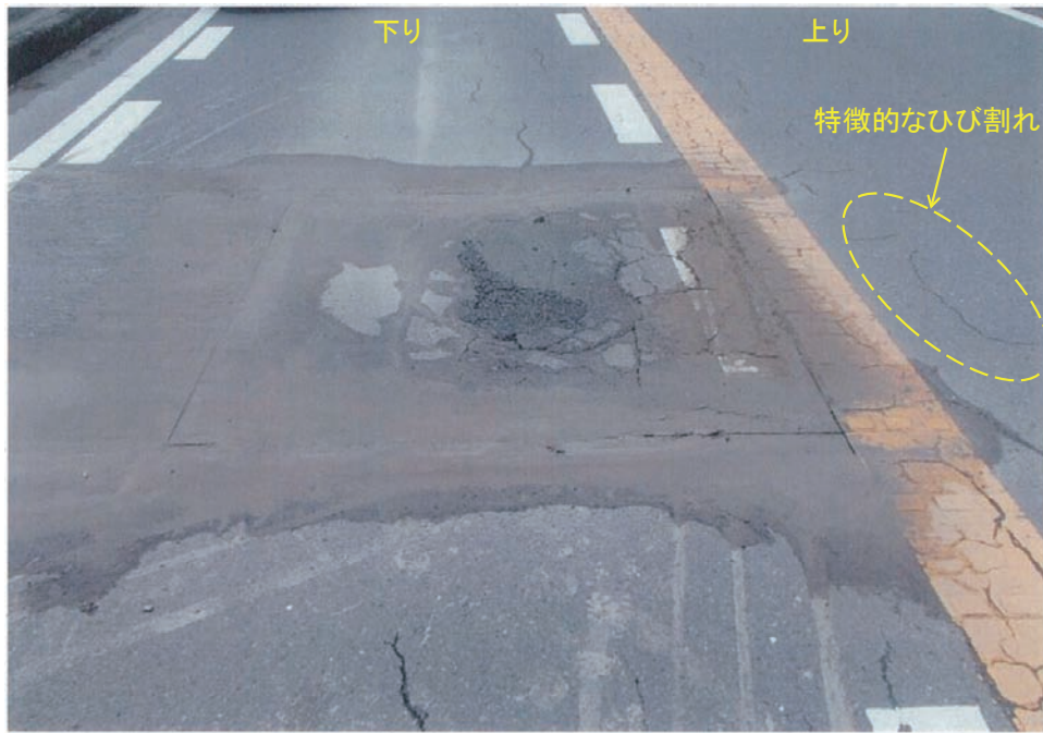
(a) 補修直前の路面, 2015年9月
