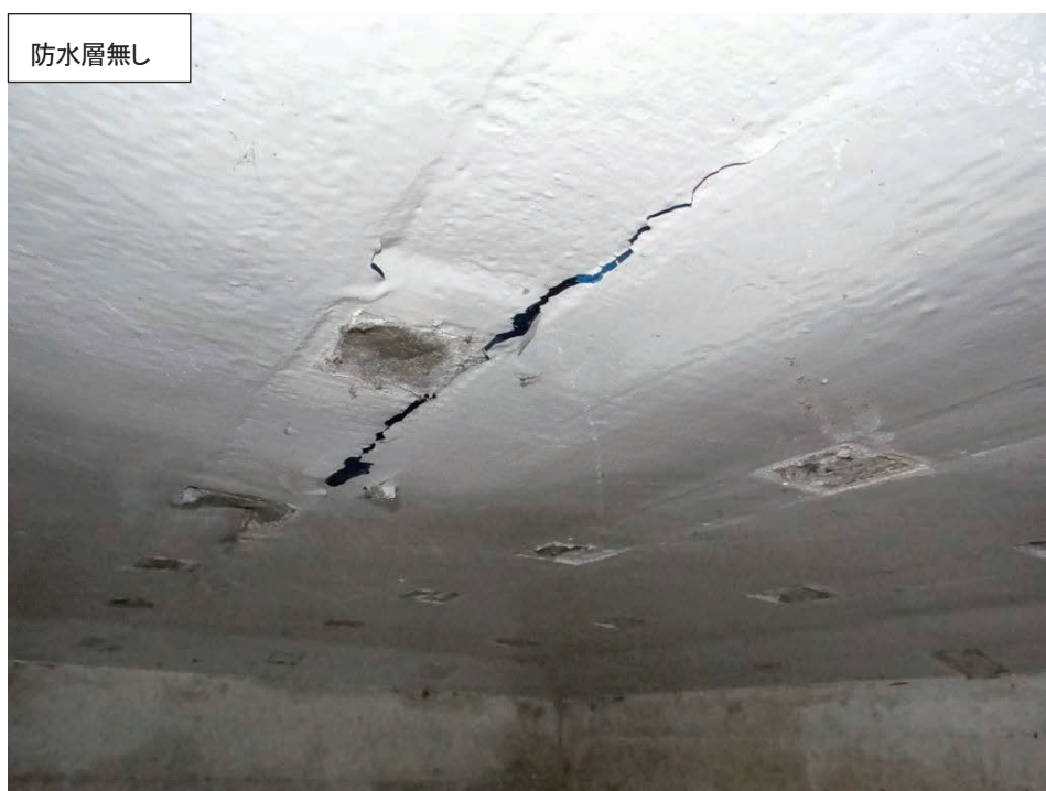
(f) 交差部と一般部の境目の剥離
