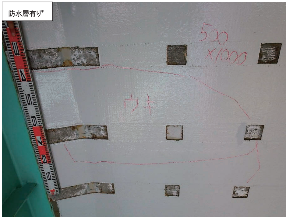
(g) ハンチ部の浮き *2010年に防水工
