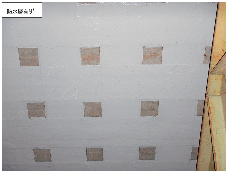
(c) 交差部（重なり部）の浮き *2009年に防水工
