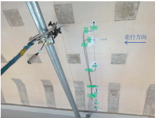
(c) 連続繊維シート 1~6 (橋軸直角) 及び 補修材 7 (橋軸方向)
