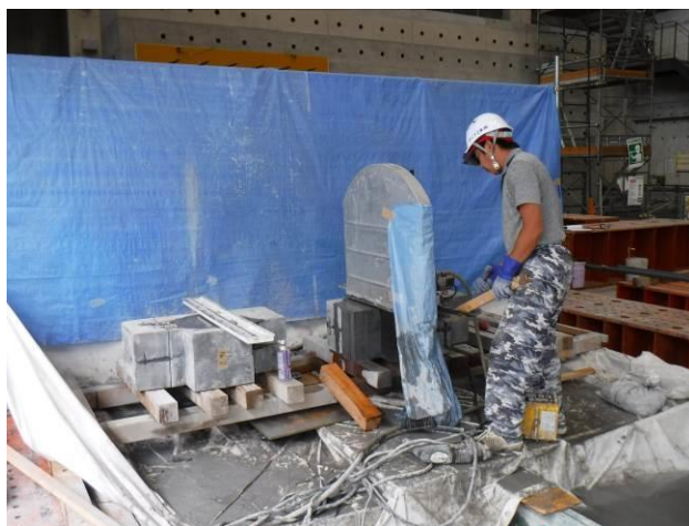
写真-4.3.5 供試体の切り出し状況
