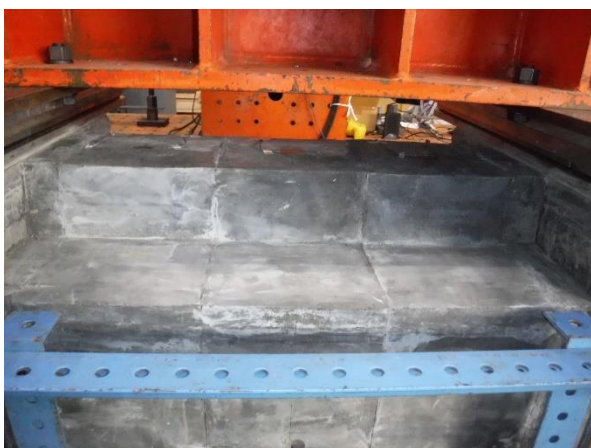
写真-4.4.28 等曲げ区間圧縮側の状況
