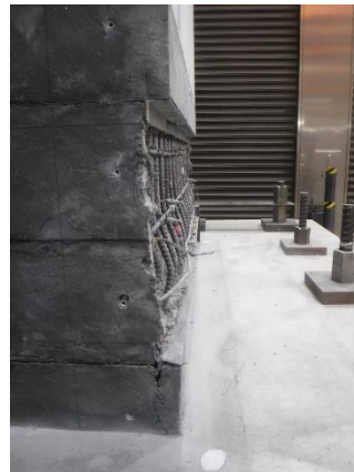
写真-4. 4. 49 補強部の損傷状態(No.2 側面から)
