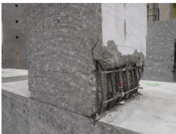
写真-4.4.88 No.1 切断面の状況
