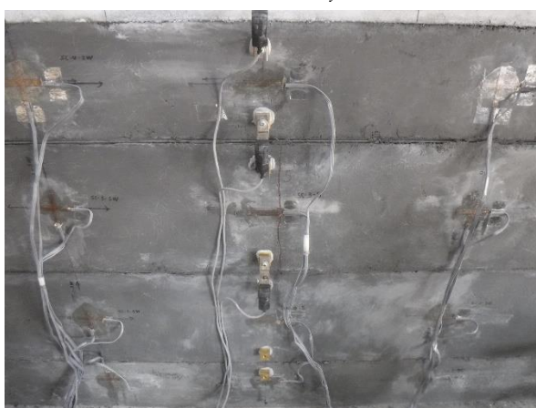
写真-4.4.80 +5 \delta (限界状態 2) 圧縮側 基部から 3 段目の補強部に縦方向のひび割れ
