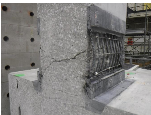
写真-4.4.92 No.3 切断面の状況
