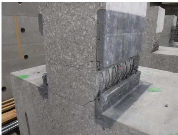
写真-4.4.90 No.2 切断面の状況
