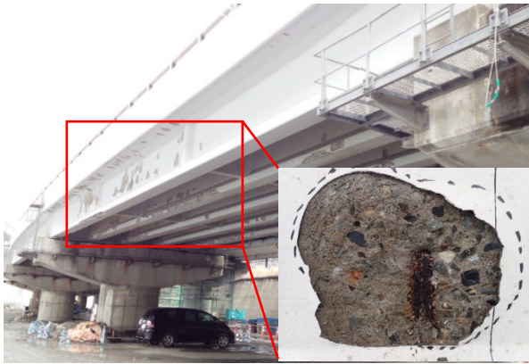
写真 1.4.3 構造本体の塩害による塗膜の剥離（損傷例）
