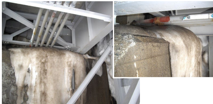
図 3-12-26 伸縮装置からの漏水及び橋台背面からの流水の凍結（鋼橋の例） 34)
