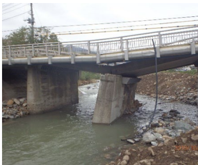
1) 直接基礎の洗掘
