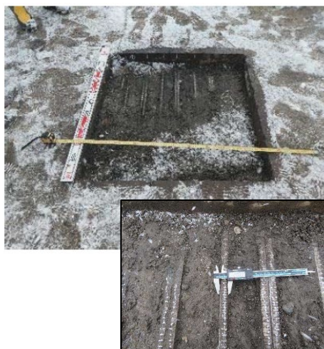
図3-3-6 土砂化による変状例
