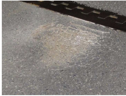
1) 舗装のひび割れ
