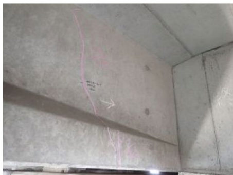
図 3-4-4 連結桁の変状例
