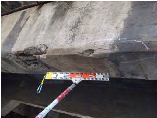
1) 飛来塩による変状
