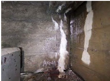
1) 伸縮装置の排水工不良
