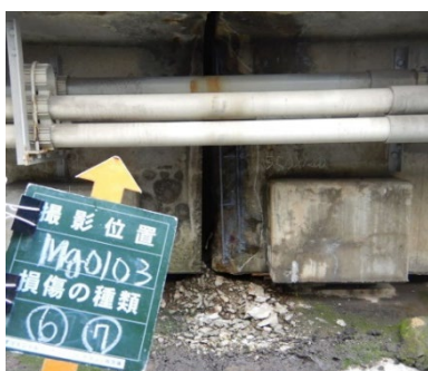
1) 伸縮装置の排水工不良
