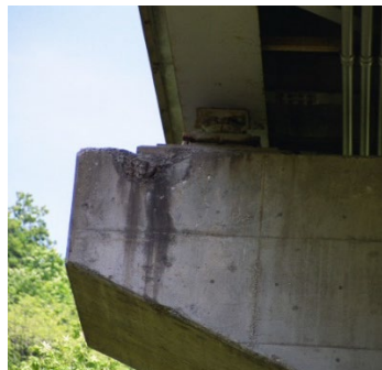
2) 凍結防止剤による塩害 (橋脚梁部)
