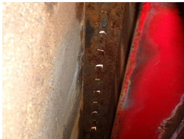
(b) 下方から見上げて撮影。樋がない。櫛歯の下面が腐食している。
