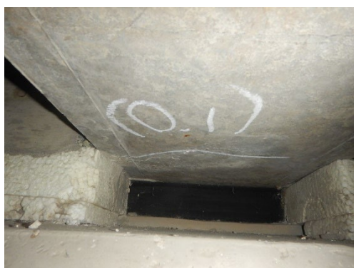
図 3-3-7 連結桁の変状例
