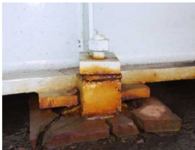
図 3-11-5 支承モルタルの凍結膨張による支承の沈下事例 25)
