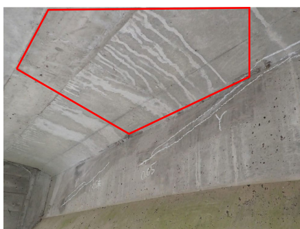
2) 床版防水工未設置
