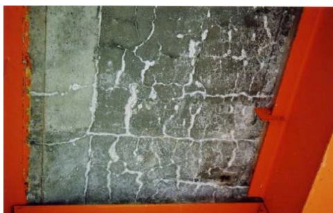
1) 床版下面の格子状のひび割れ
