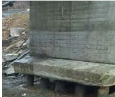
2) 杭基礎の洗掘
