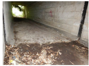
3) 継手部の段差
