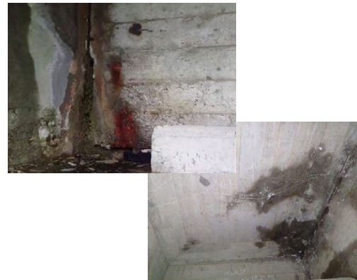
2) 凍結防止剤による変状
