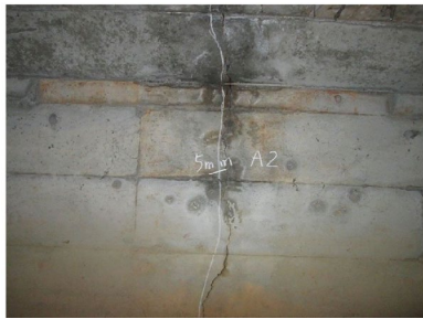
1) 連続したひび割れ
