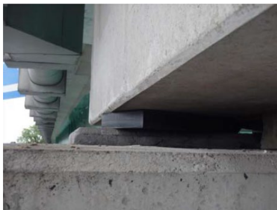
図3-11-7 パッド型ゴム支承のズレ・逸脱の事例
