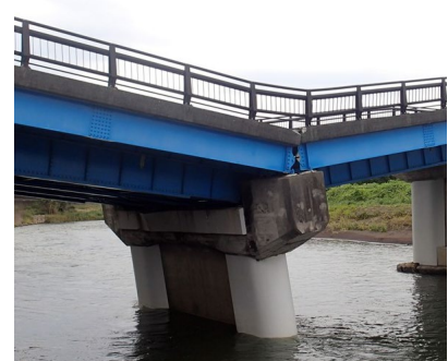
3) ケーソン基礎の洗掘
