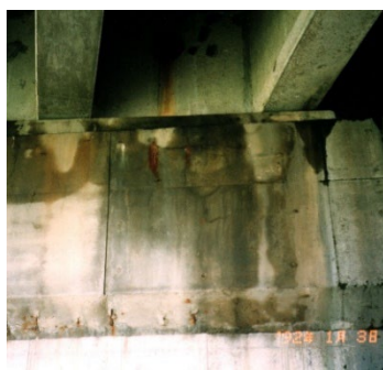
1) 飛来塩による塩害 (橋台堅壁前面)
