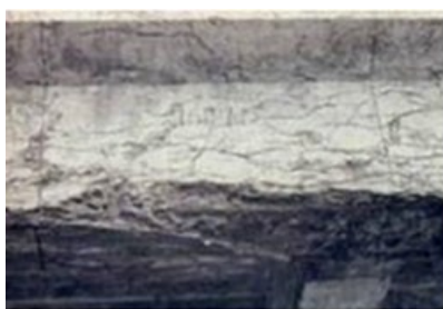
1) 微細ひび割れ
