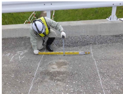
図 3-6-7 RC 溝橋の圧縮沈下による変状事例 (RC 溝橋と盛土の境界部に生じた路面の段差)
