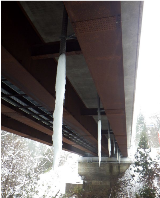
図 3-13-10 流末水の凍結事例 59) (12月中旬、前夜に降雨なし、最低気温-4°C)
