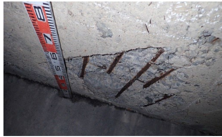
図3-3-10 製作・施工不良による変状例
