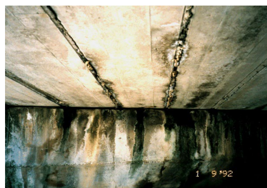
2) 凍結防止剤による変状
