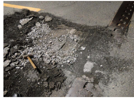
2) 床版コンクリート上面の土砂化
