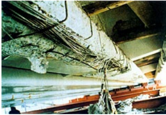
1) 飛来塩による変状
