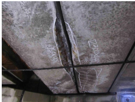
図3-3-11 防水・排水工不良による変状例
