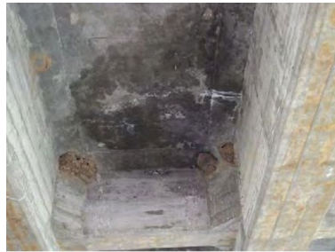
2) 床版防水工未設置
