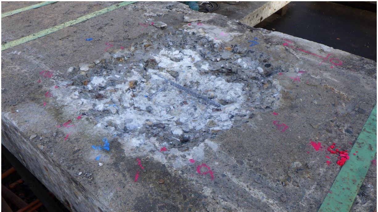
写真-5.1.5 深層土砂化の模擬状況①（撤去床版活用供試体 No.2）
