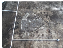
① 床版補修痕
