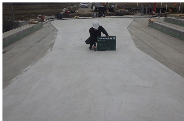
写真-1.1 調整コンクリートの状況
