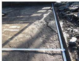
③ 表面劣化
