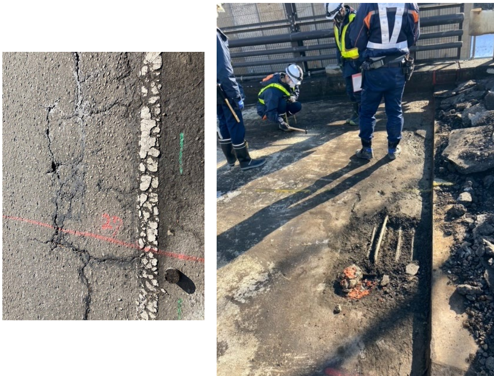
図-4.8.11 床版の土砂化状況
