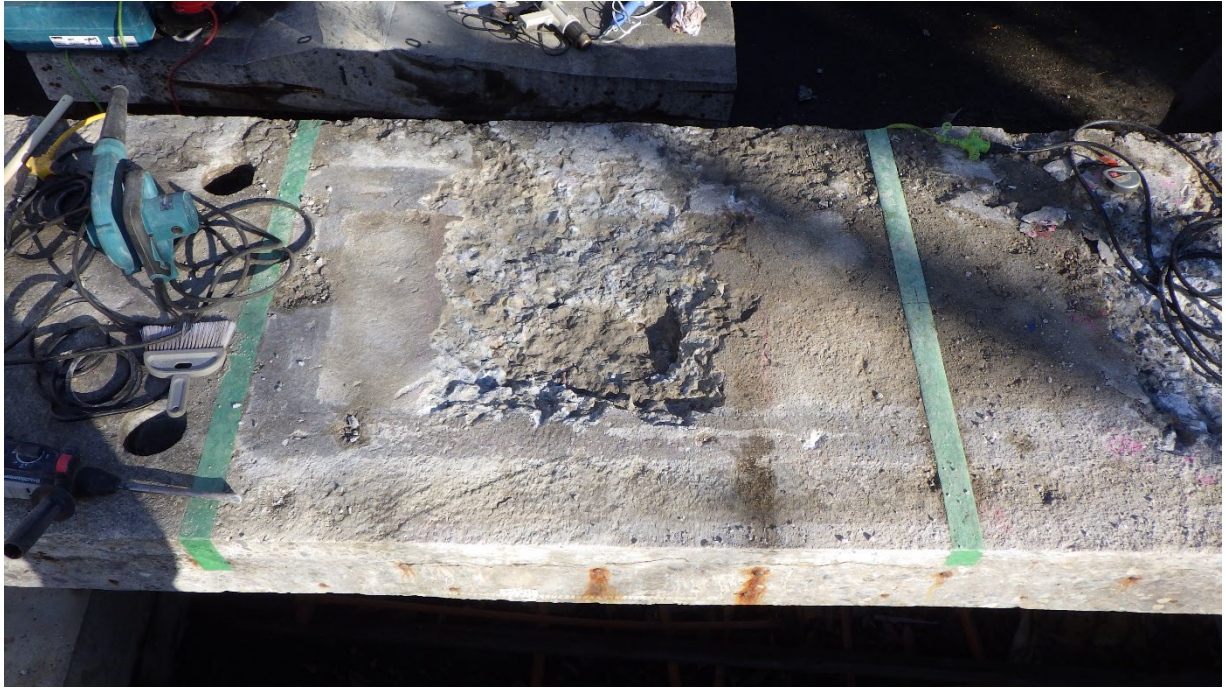
写真-5.1.8 軽微土砂化の模擬状況②（撤去床版活用供試体 No.2）
