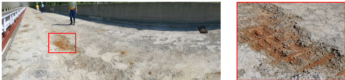
図-1.1 舗装開削後の土砂化が進行した事例
