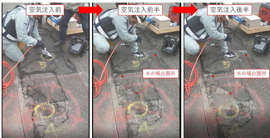
図-3.2.4 空気注入による床版内部の滞水状況の確認
