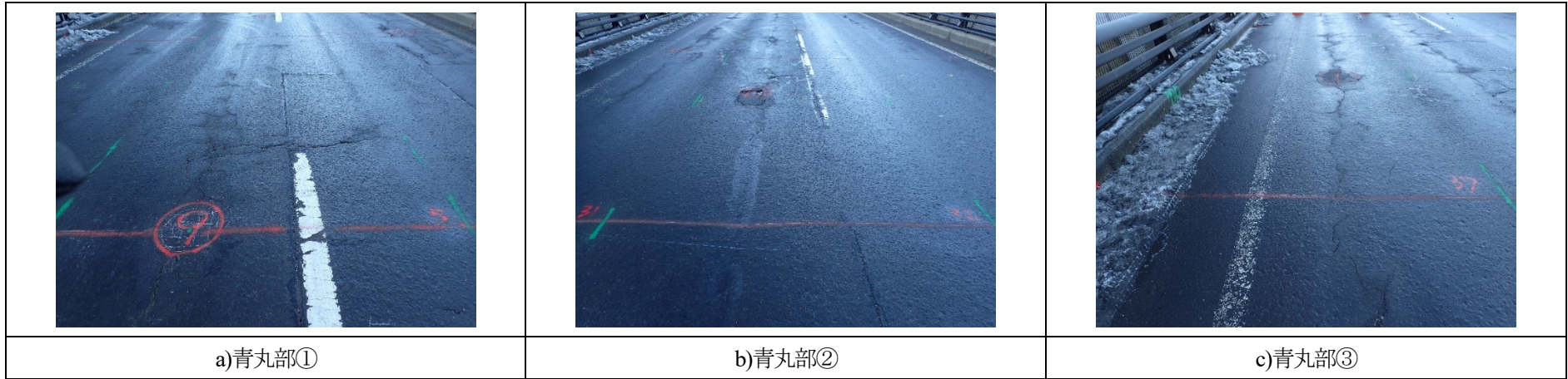
写真4.3.2 青丸部①②③周辺の路面写真
