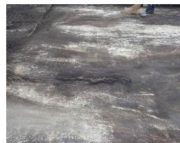
② ひび割れ
