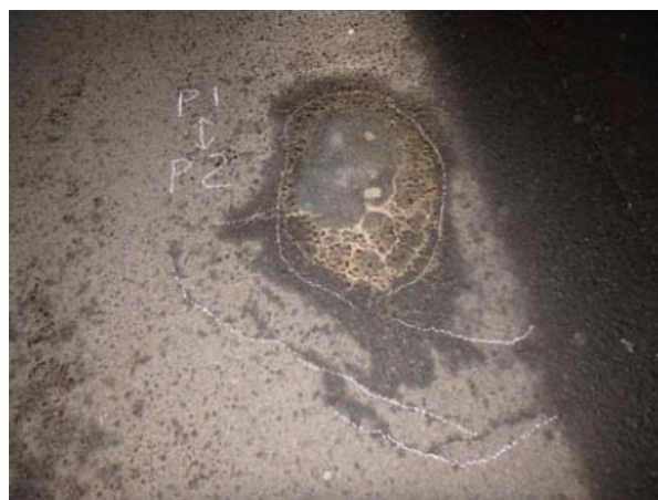
写真-3.1.4 土砂噴出（路面損傷図内の写-78）
