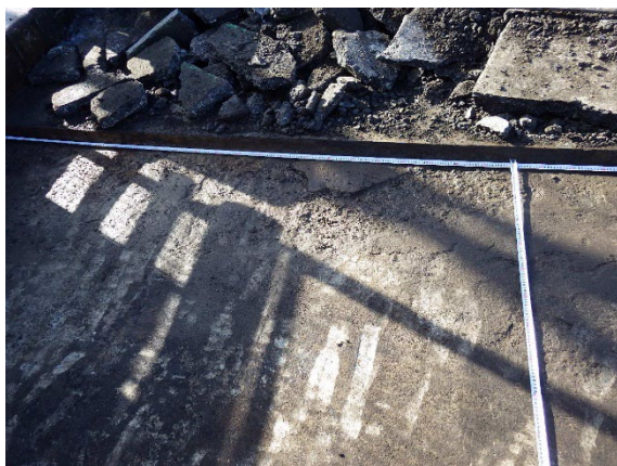
e) 表面劣化 (写真3) の青丸部
