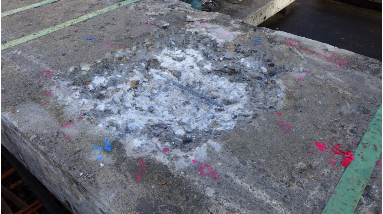
写真-5.1.6 深層土砂化の模擬状況② (撤去床版活用供試体 No.2)
