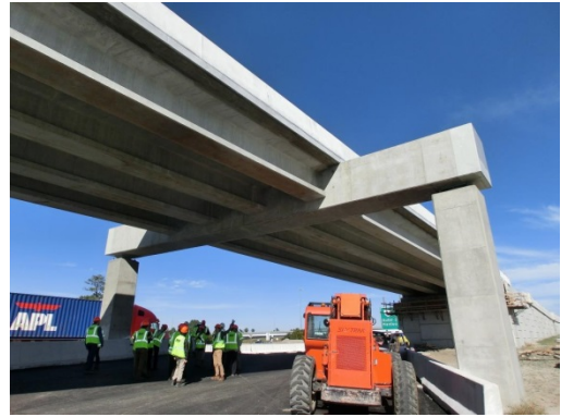
写真-5 現地調査の様子（チェサピーク市の4車化事業での新設橋梁工事現場）
