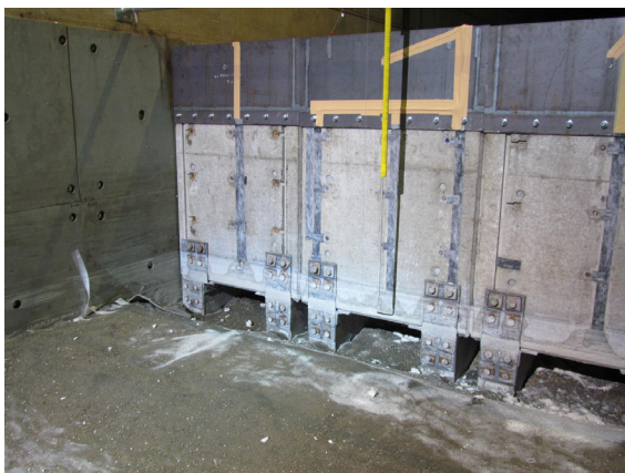
写真-7 防潮壁に対して津波のみ作用させたあとの様子
