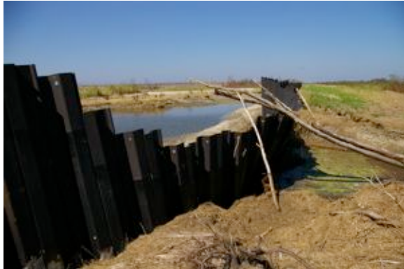
(位置5) 矢板の高さがバラバラになっている。
