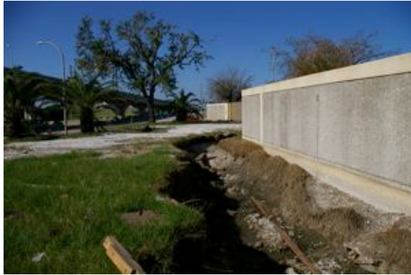
このfloodwall背後の洗掘状況。
