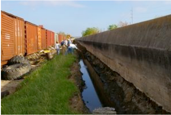
破堤部周辺の堤内側洗掘状況
