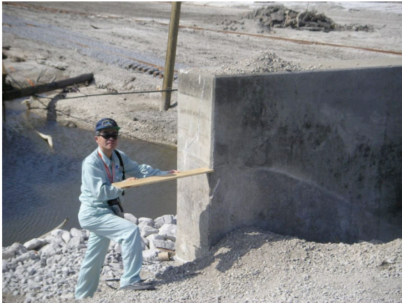
破堤地点2 コンクリートのfloodwallとそれより低かった道路との接続部の破堤状況
