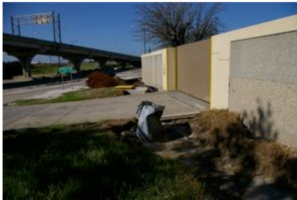
Floodwall背後の洗掘状況。
