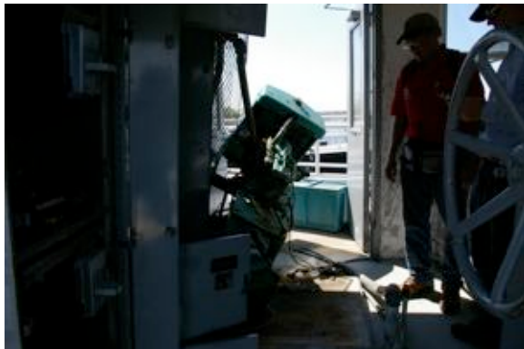
(位置6) もぎ取られた緑色の発電機。
