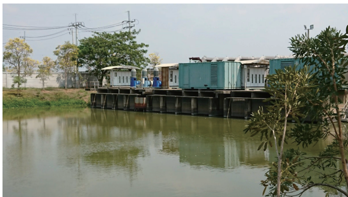
Drainage pumping station in Rojana Industrial Park ロジャナ工業団地内のポンプ排水機場
