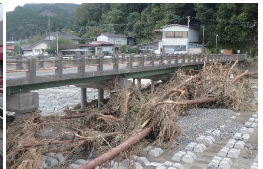
Photo 2. Driftwood accumulated in Tokiwa Bridge 写真 2 常盤橋に集積した流木
