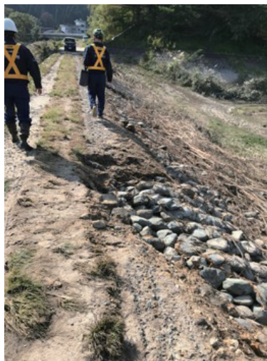
Photo 5. Eroded the bank slope 写真 5. 侵食された堤防裏のり
