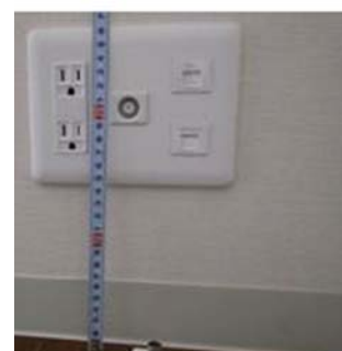
床から 20cm に差込口があるコンセントとモジュージャック
