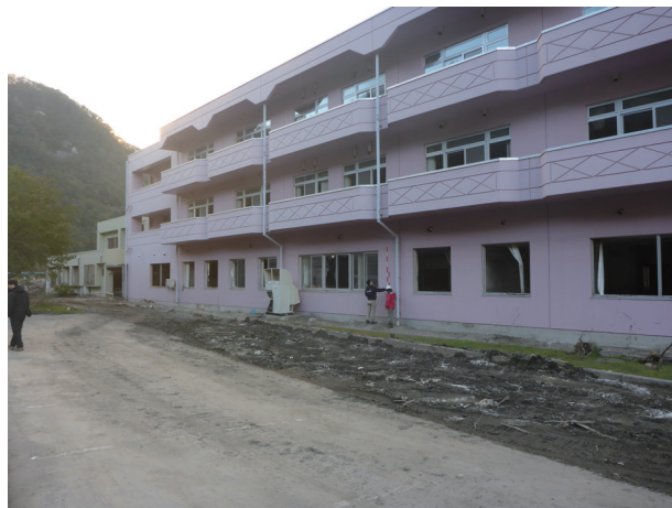
写真 3. 2-18 建物の壁には地表から 3m 地点に浸水痕が観察できる
