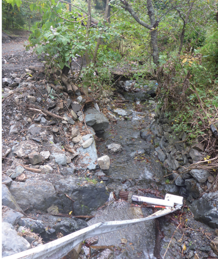
写真 3. 3-2 航空写真で「土石流発生」と判読された沢の状況（写真手前が上流側）
