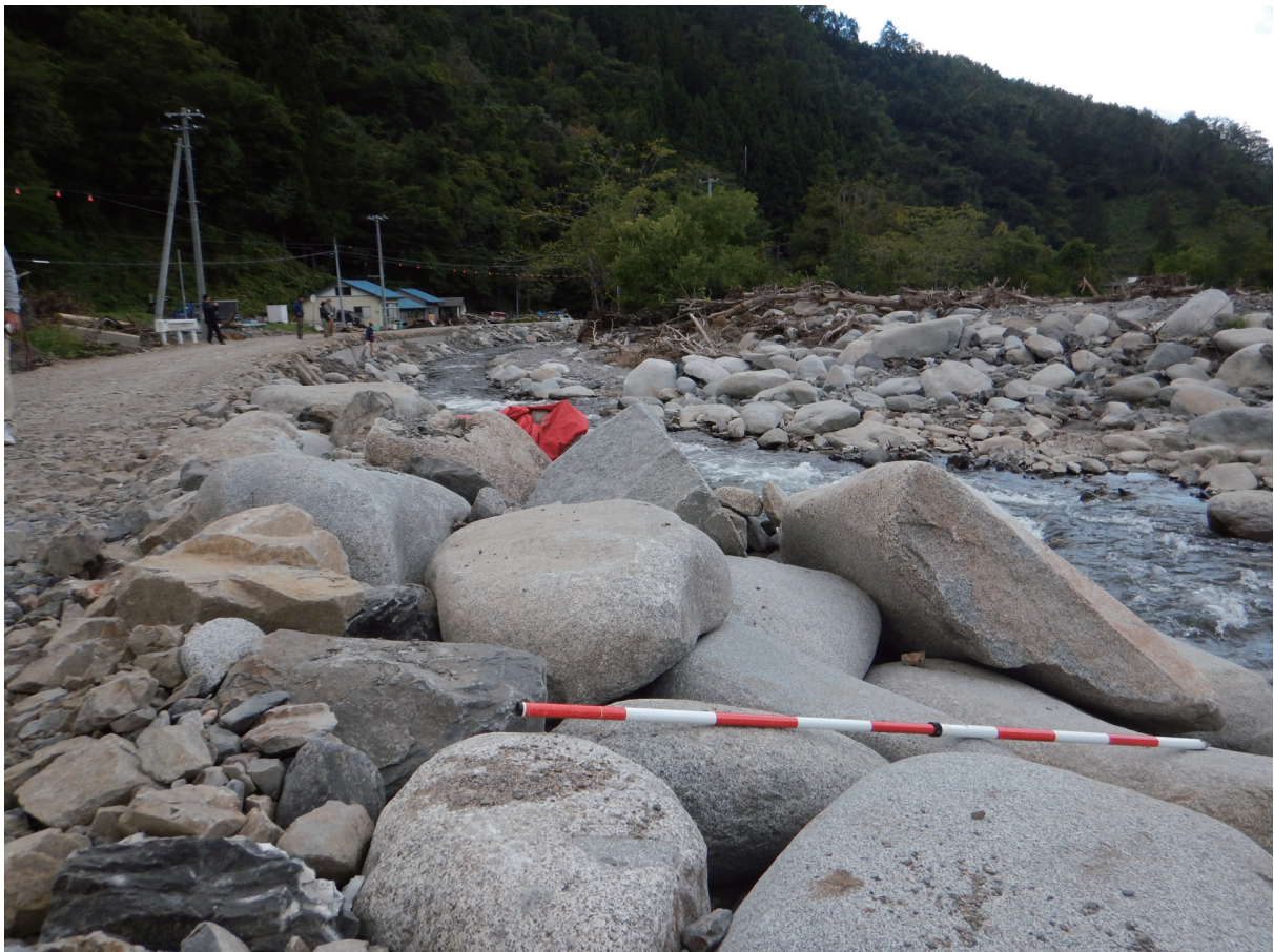
写真 3.3-1 鼠入川の河床に見られる巨礫，写真左側の道路は被災しており復旧工事中 (写真手前が上流側)
