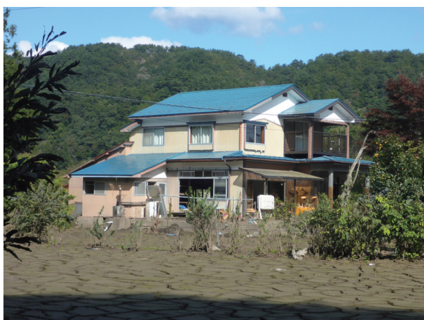
写真 3. 2-27 小本川、中島地区卒郡の家屋、床上浸水したため、清掃作業中
