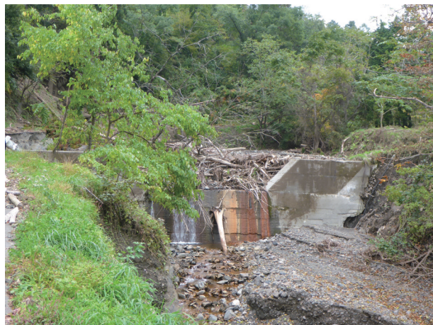
写真 3.2-6 大沢川、砂防堰堤に土砂と流木が捕捉される
