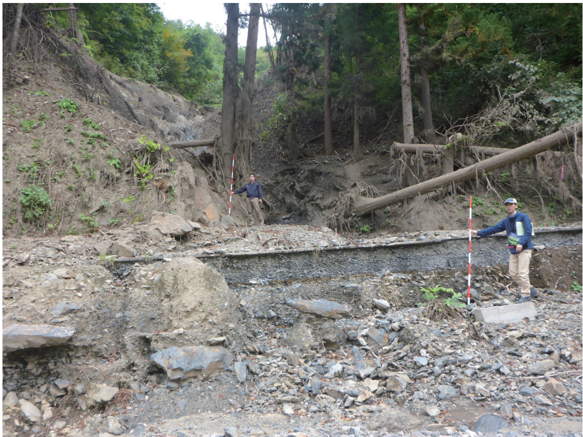
写真 3. 3-6 土石流が発生した沢（写真奥が上流側）
