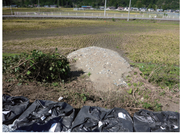
写真 3. 2-30 小本川、左岸堤防の損壊、土嚢で応急処置が施されている
