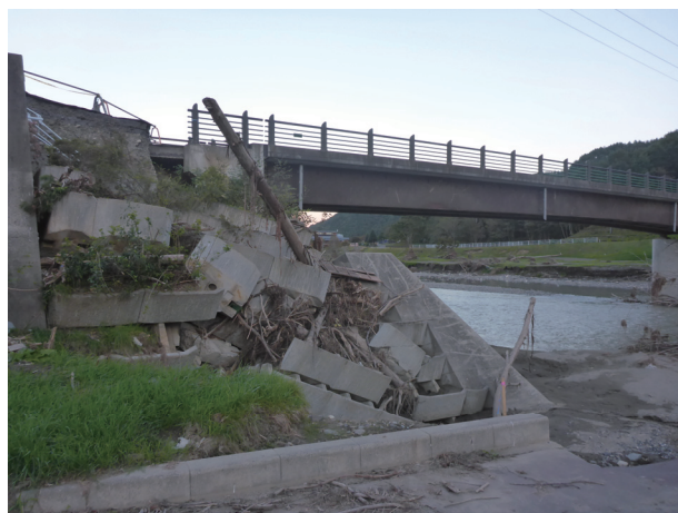
写真 3. 2-20 小本川、橋台の損傷と土砂、流木の堆積
