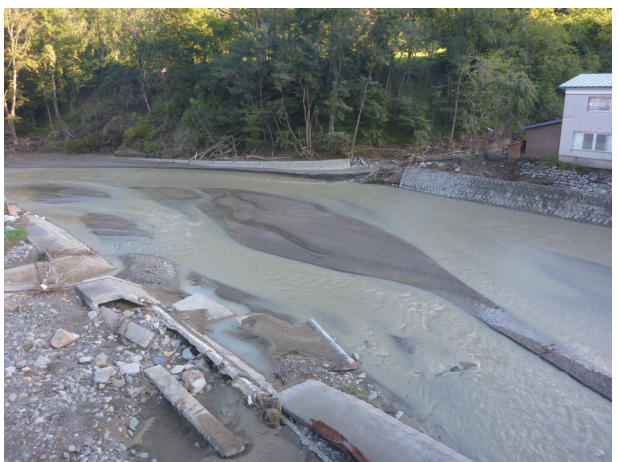
写真 3. 2-16 小本川、護岸が損傷し、河床に砂州が形成されている
