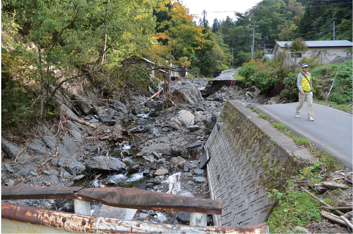
写真 3. 3-5 大沢川の状況 道路が損壊しているため通行できない（写真上が上流）
