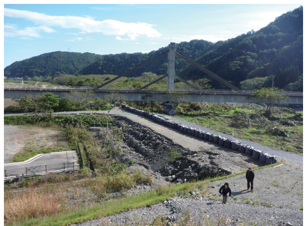
写真 3. 2-34 小本川左岸、小本地区の越水箇所、近隣の家屋は床下浸水
