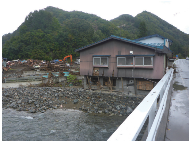
写真 3.2-4 小本川（手前）、三田貝川（奥）が写真左手で合流、家屋の壁に残る浸水痕は調査時の小本川水面から約 3.4m
