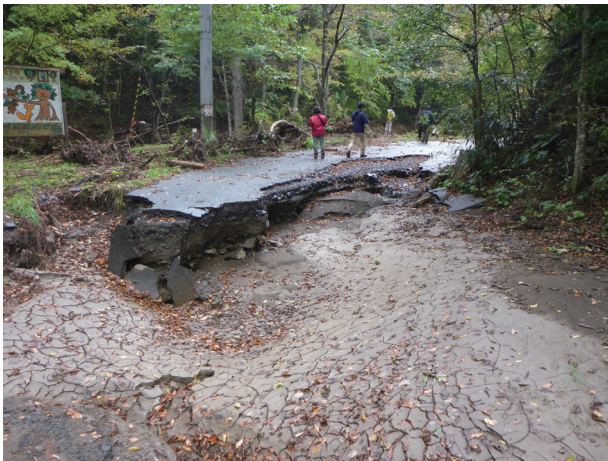
写真 3.2-1 写真奥から手前に三田貝川が流下、道路のアスファルトが削られ、土砂が堆積
