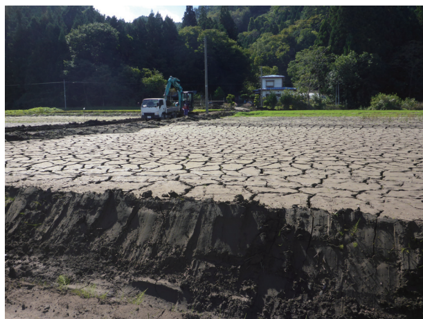
写真 3. 2-26 小本川、中島地区卒郡の土砂堆積、水田に厚く土砂が堆積したため、除去作業中
