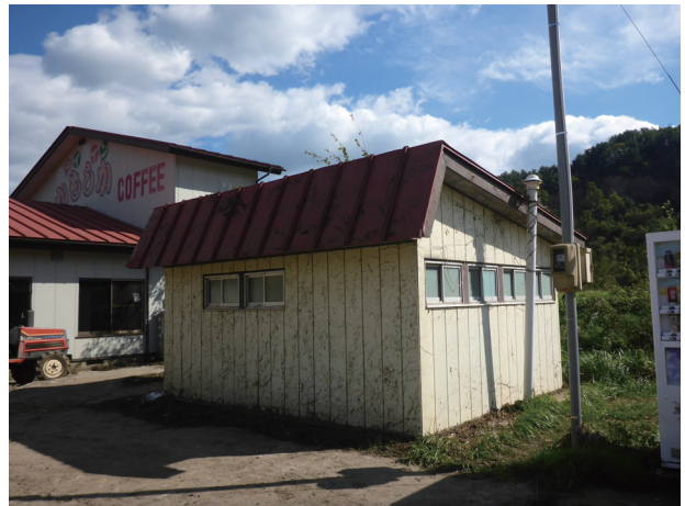
写真 3. 2-32 小本川、中島地区の建物、側面すべてに植物片が付着し、水没したと思われる
