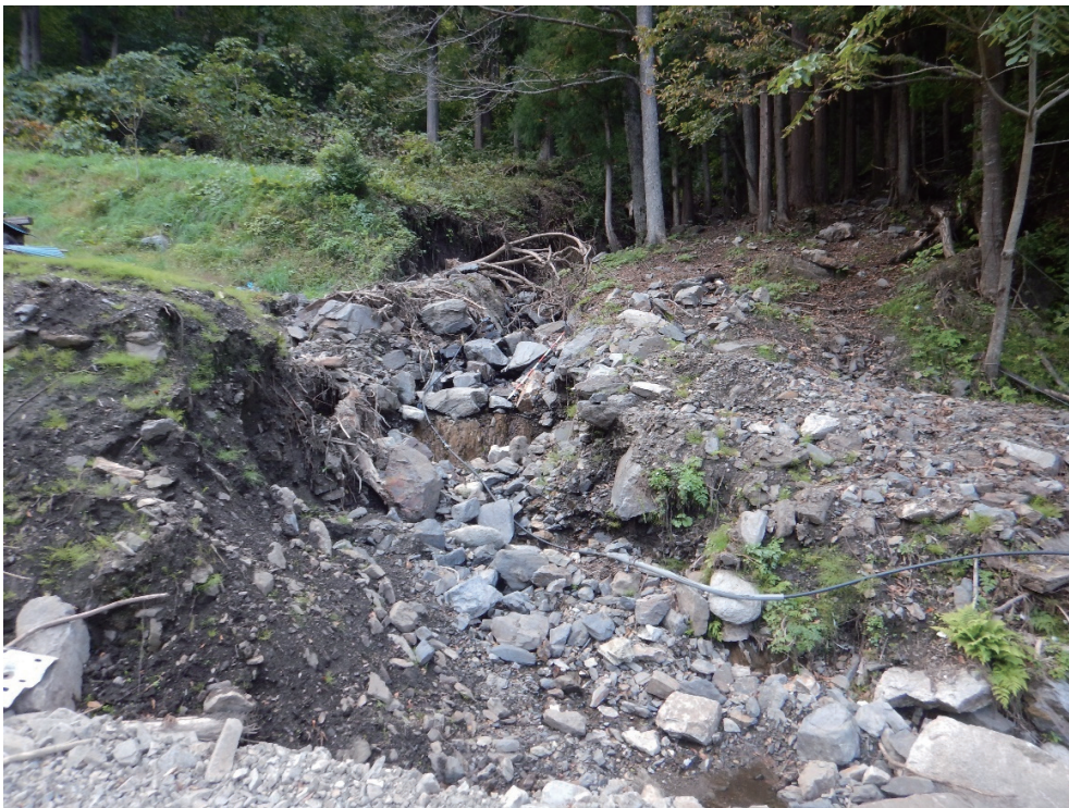
写真 A-1 鼠入川の支川の土砂堆積物の状況（写真 3. 3-3 の付近）（写真奥が上流）
