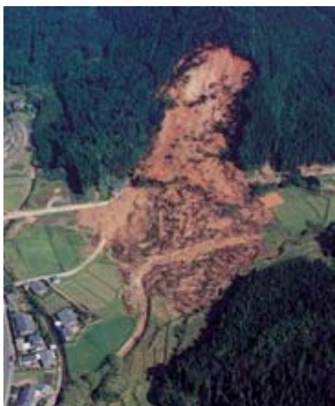
図-1 大変位した地すべりの例(鹿児島県)
