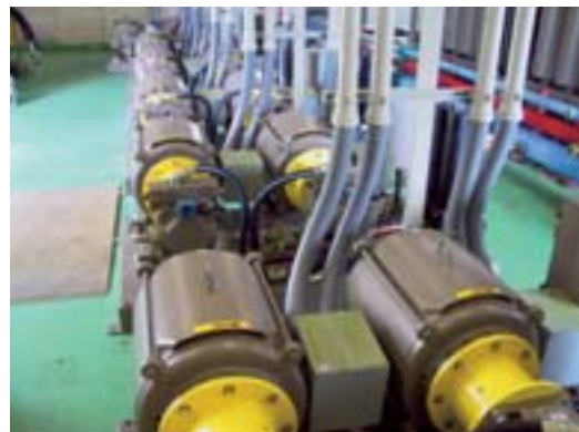
【三次元大型振動台油圧システム改良】 油圧源室に設置した油圧ポンプ群
