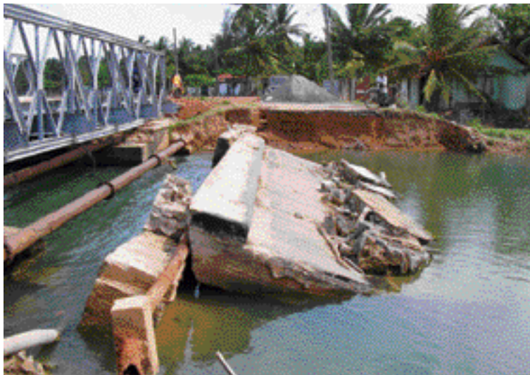
写真 - 2.3.2.8 津波により橋台裏が洗掘されて落下した橋と仮設橋（スリランカ）
