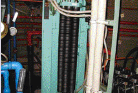
【コントロール弁】
