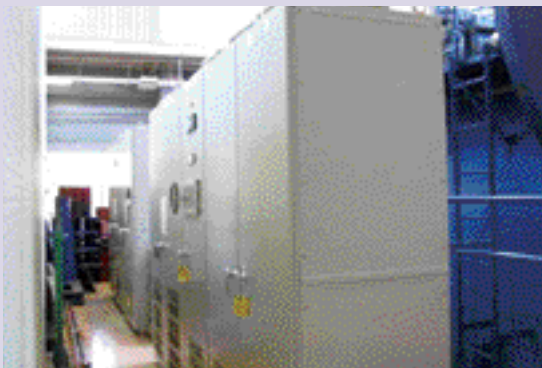
【制御盤（全更新）】
