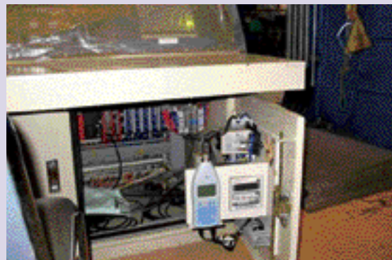
【操作盤（盤内の部分改修）】
