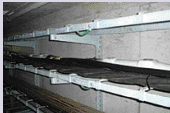
【同左（共同溝内敷設状況写真）】
