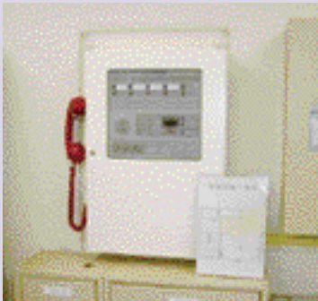
【火災報知装置盤】
