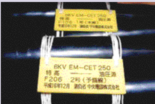
【新6600V配線（近接写真）】
