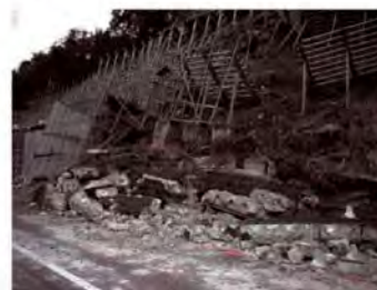
写真-4 一般国道17号川口町牛ヶ島(262.5KP)でのブロック積擁壁の崩壊（山側のブロック積擁壁が約20mにわたって崩壊）
