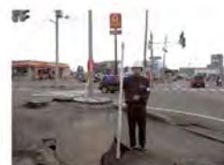
下水道管路の地震被害
