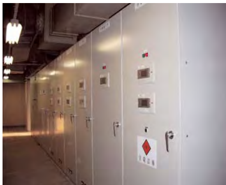
写真-7.1.1.7 更新した高圧ケーブル (特別高圧受変電施設から左写真のサブ変電所へ送電する6000Vケーブル。)
