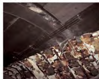
写真-2 一般国道17号和南津トンネル（覆工コンクリートが剥落した箇所では、鋼製支保工が露出している）
