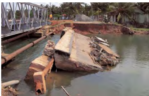
写真-2.3.2.13 津波により橋台裏が洗掘されて落下した橋と仮設橋 (スマトラ島沖地震・インド沖地震)
