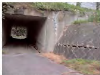
写真-5 関越自動車道を横断するボックスカルバートの被害
