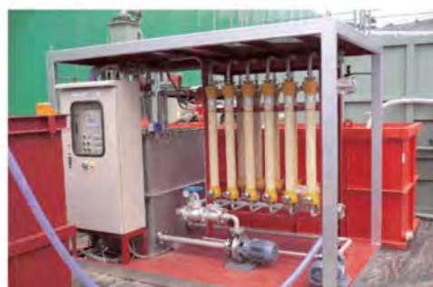
ダイオキシン類に汚染された排水を、環境基準や排水基準まで浄化可能な「カートリッジ式膜モジュールシステム（MFMシステム）」
