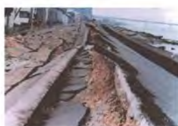
淀川堤防の地震被害
