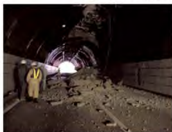
写真-1 一般国道17号和南津トンネル（長岡側坑口より約85mの地点で覆工コンクリートが落下）
