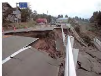
写真-3 一般国道17号川口町天納(263.46KP)での道路崩壊（沢浴いで、幅約40mにわたってすべり破壊）
