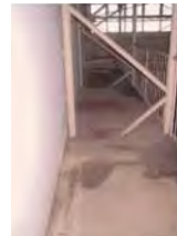
内部の雨漏れ状況
