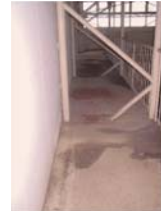
内部の雨漏れ状況
