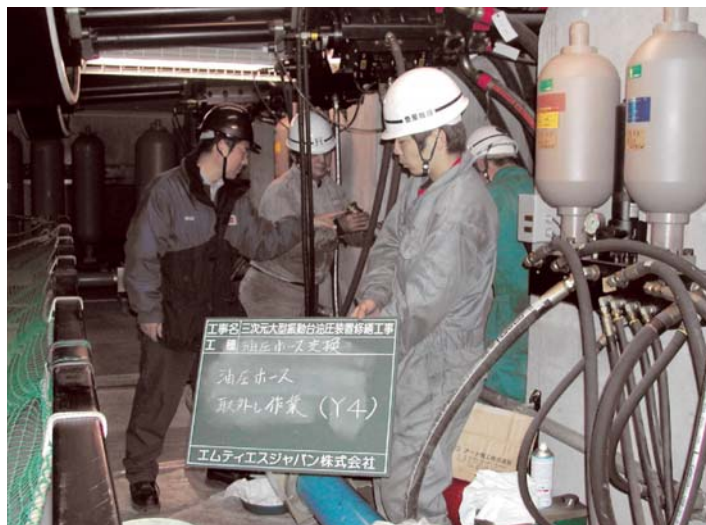
三次元大型振動台の油圧回路修繕三次元大型振動台油圧ユニット のサーボ弁オーバーホール（取付）
