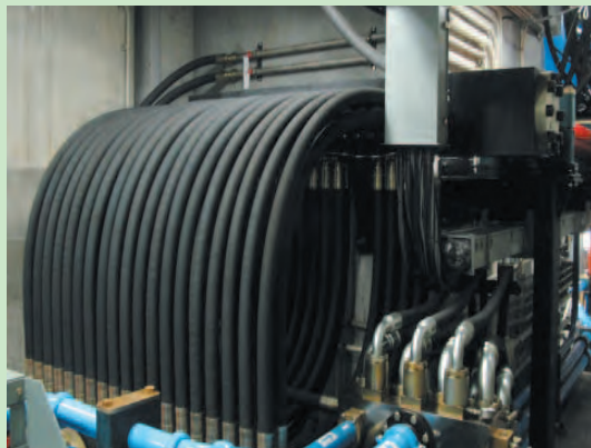
【更新した三次元大型振動台の油圧ホースの一例】
