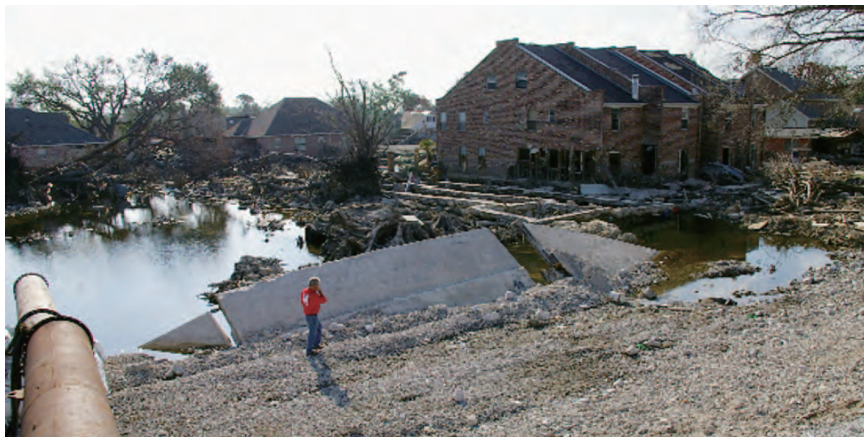
写真－ 2.3.2.12 17th street Canalの破堤地点の被害状況
