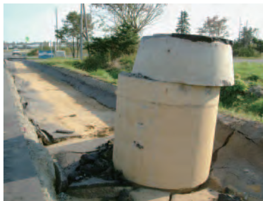
図－3 平成15年十勝沖地震において埋戻し部の液状化により浮き上がったマンホール
