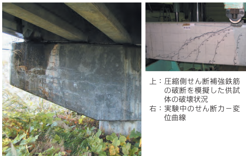
図-1 ASRにより多数のひび割れが生じた橋脚
