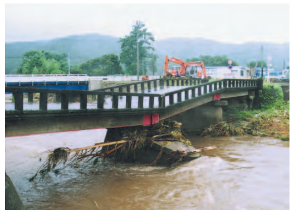
写真-1 洗掘による橋脚の傾斜
