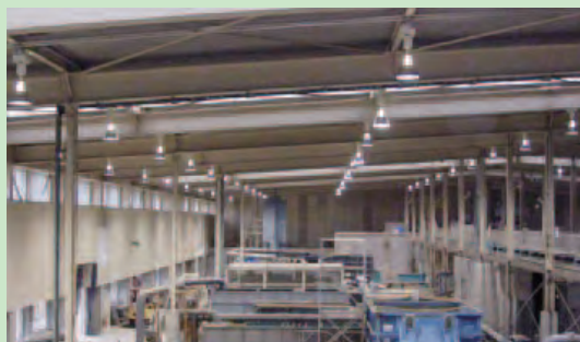
【改修した照明設備】
