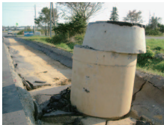
図-3 平成15年十勝沖地震において埋戻し部の液状化により浮き上がったマンホール
