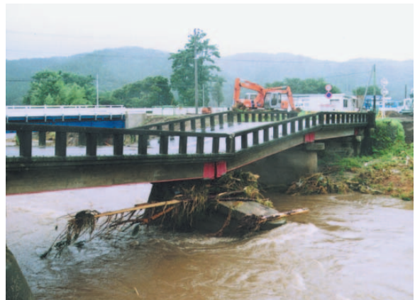
写真-1 洗掘による橋脚の傾斜
