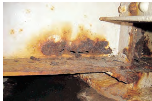
写真 桁端部の腐食事例
