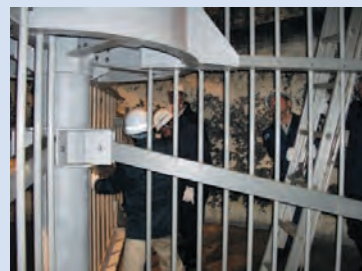
小樽市銭函下水終末処理場に設置された濃縮装置とその点検
