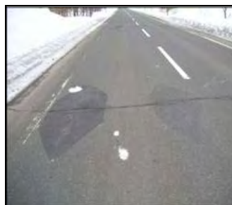
写真 温度応力によるひび割れ
