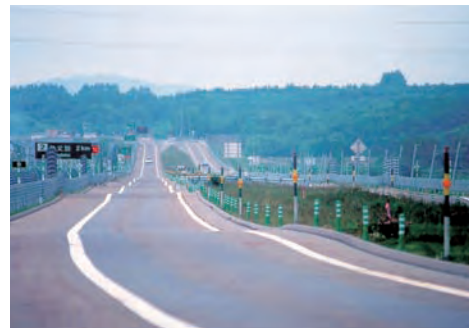
写真-11.1 泥炭性軟弱地盤の供用後沈下
