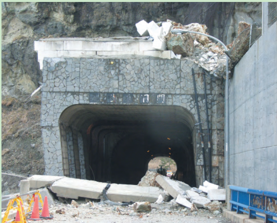
【国道 249 号八世乃（はせの）洞門の復旧に関する指導】
