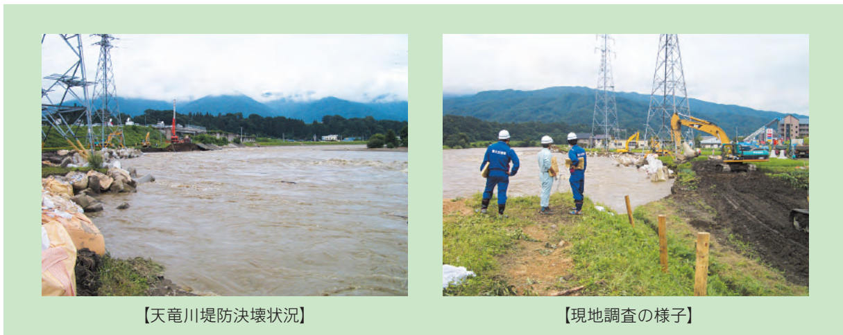
写真－1.5.1.3 豪雨で決壊した天竜川堤防の現地調査
