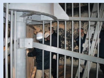
小樽市銭函下水終末処理場に設置された濃縮装置とその点検
