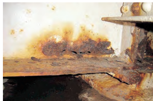
写真 桁端部の腐食事例
