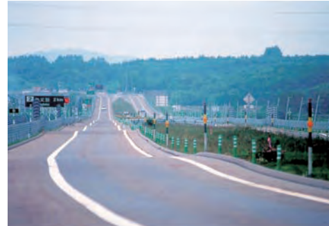
写真-11.1 泥炭性軟弱地盤の供用後沈下
