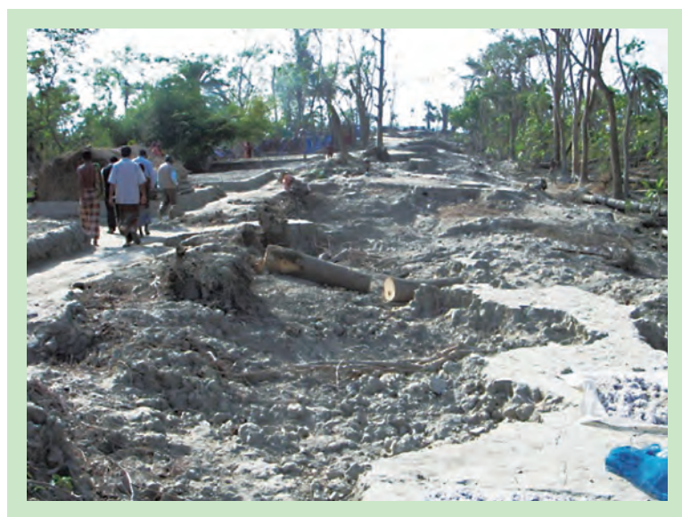
写真－1.6.1.8 バングラデシュ南部をおそったサイクロンシドルによる高潮によって破壊された堤防
