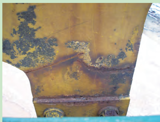
【白砂大橋の亀裂】
