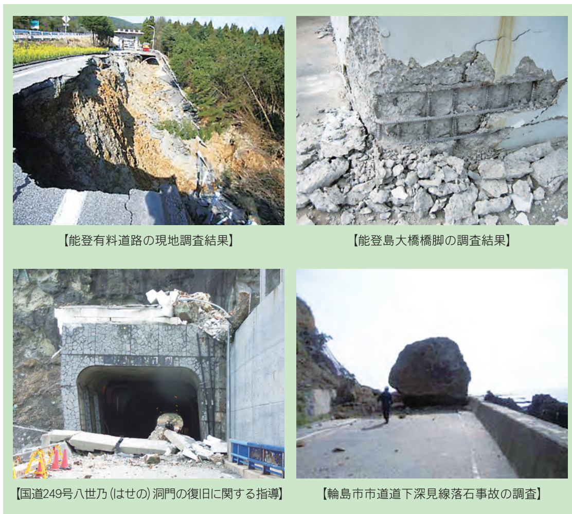
写真－1.5.1.2 能登半島地震における被害調査と復旧指導の状況
