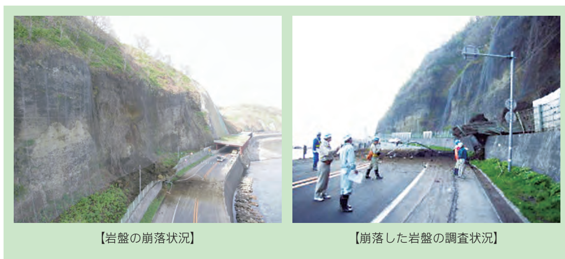
写真－1.5.1.3 小樽市忍路海岸岩盤崩落における現地調査の状況
