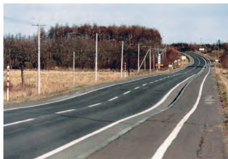
写真 11.1 長期にわたり沈下が発生し、路面が波打つ泥炭地盤上の道路
