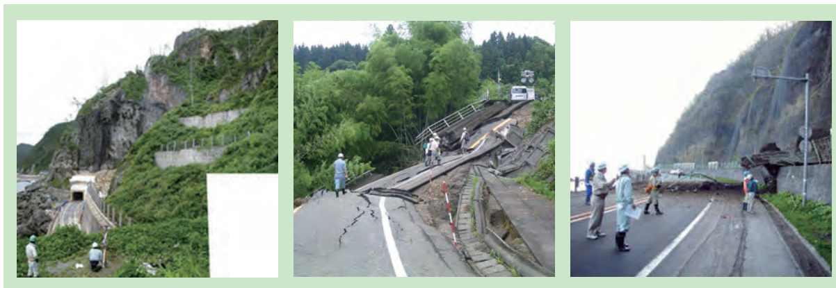
能登半島地震時における崩壊現場の緊急計測技術適用による技術的支援
