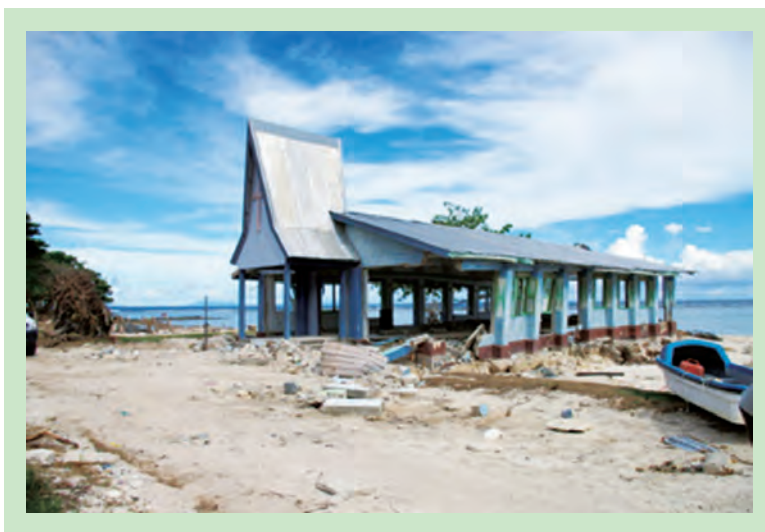
写真－1.6.1.7 ソロモン沖地震津波で被災したギゾ島の教会周辺の住居は完全に破壊されている
