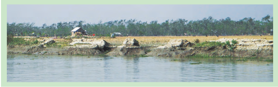
写真－1.5.2.16 バングラディッシュサイクロン被害 高潮で破壊された堤防（海側より望む）
