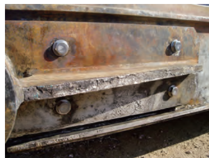
SUS304の腐食事例
