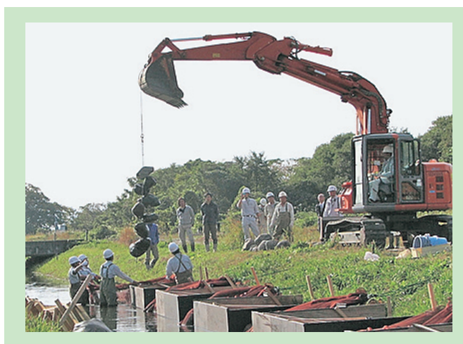
写真-1.5.13 ワイヤで連結した石礫を重機で吊り上げている状況
