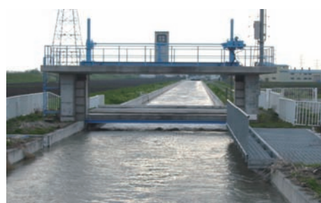
写真 17.2 幹線用水路の水位調整ゲートの例
