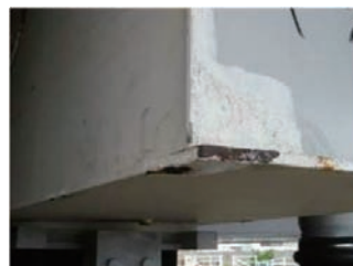
新設橋打痕傷部
