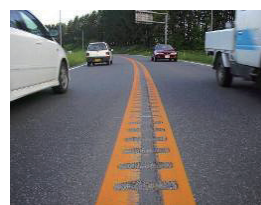
写真 7.9 正面衝突事故対策 (ランブルストリップス)
