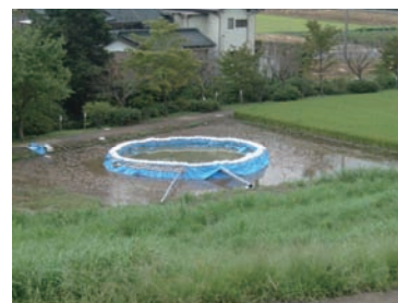
写真 2.2 基礎地盤漏水
