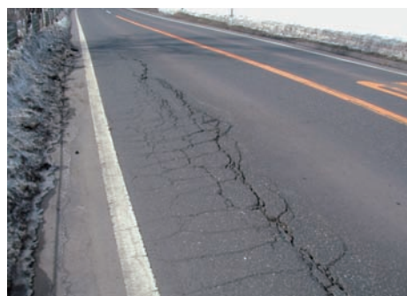
写真 11.4 融解期の路床の支持力低下によるクラック
