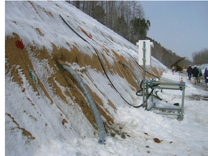
凍上が発生したのり面の現地計測
