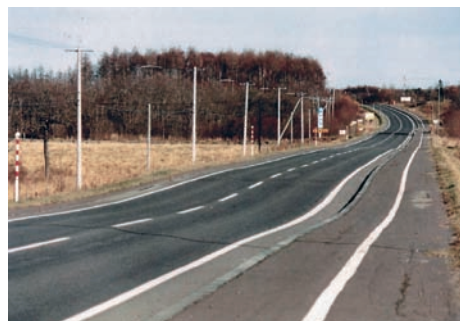
写真 11.1 長期にわたり沈下が発生し、路面が波打つ泥炭地盤上の道路
