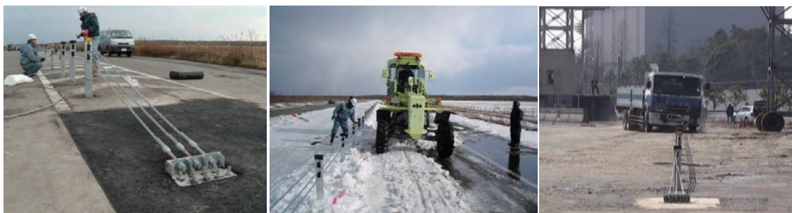
ワイヤーロープ式防護柵の導入可能性検討試験状況（左：施工方法の確認、中：除雪方法の検討、右：衝突実験）
