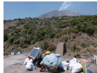
自動降灰量計の設置状況
