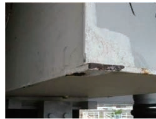
新設橋打痕傷部
