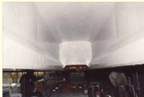
写真 - 1 損傷を生じたコンクリート構造物の補修事例 (上：補修前、下：補修後)
