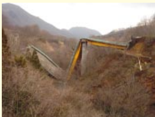
倒壊した祭時（まつるべ）大橋
