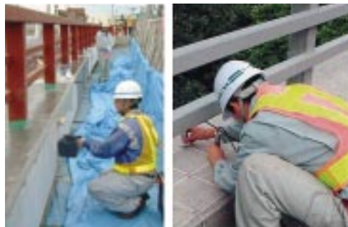
写真11.2 コンクリートの耐久性向上のための表面含浸材の塗布、計測状況
