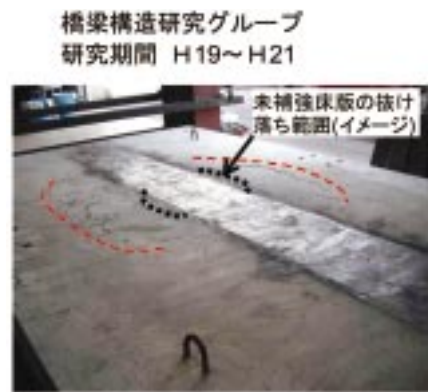
鋼板接着補強された鉄筋コンクリート床版供試体の抜け落ち範囲
