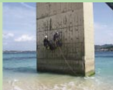
瀬底大橋における塩害調査
