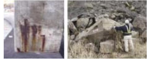
落石覆道柱部の劣化損傷例および背面部への落石状況
