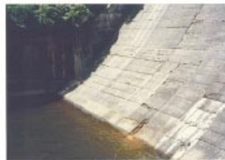
ダム堤体に発生した劣化事象の例（漏水）
