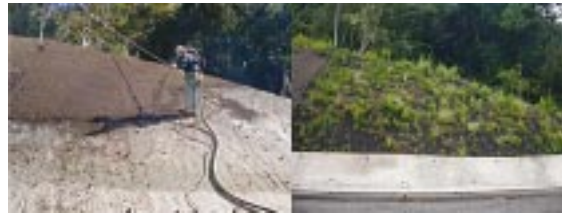
法面緑化工法の吹き付け作業の様子（左）と施工後8ヶ月の様子（右）
